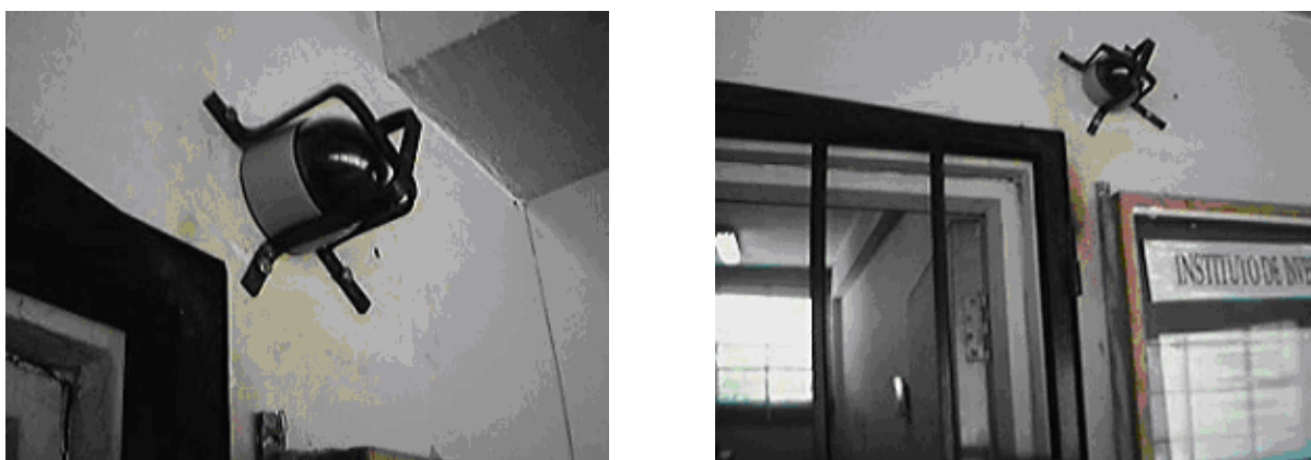
Fig. 8.58 Cámara con los soportes para su protección.
