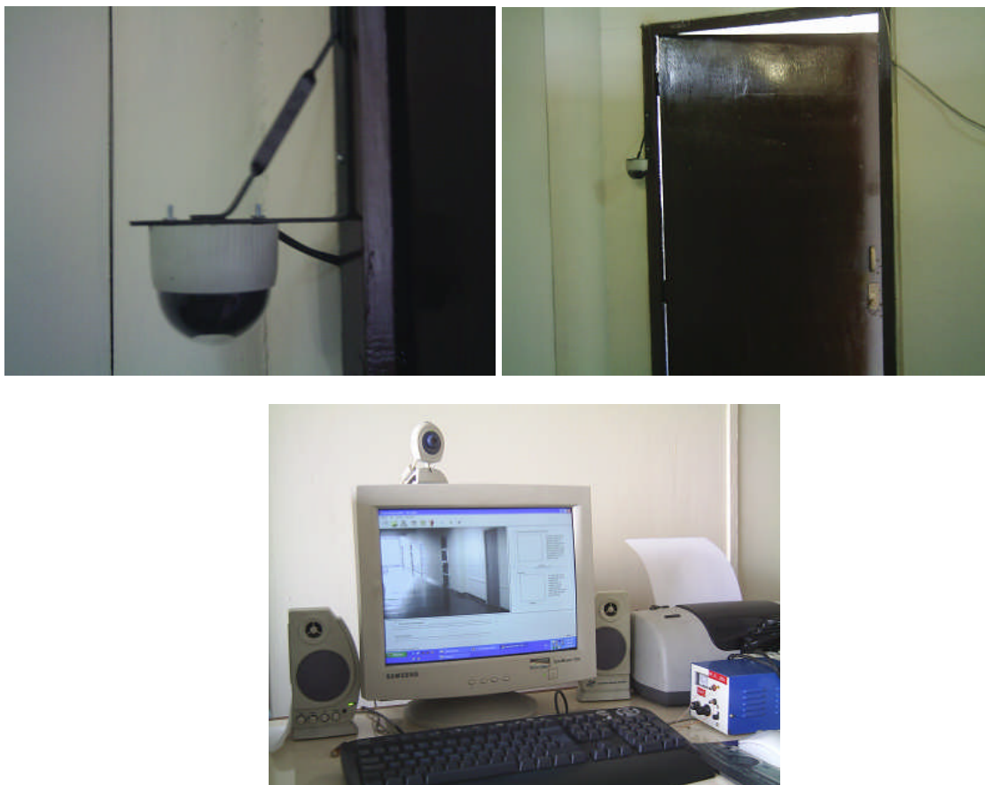
Fig. 8.62 instalación en otro ambiente del centro de investigación y desarrollo a modo de prueba.
