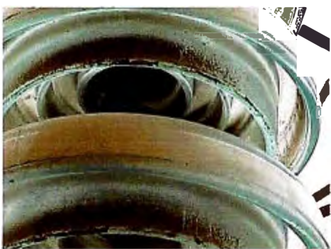
Foto : Insulator # B125-4 – in the wind Aislador cadena B125-4 vista al viento
