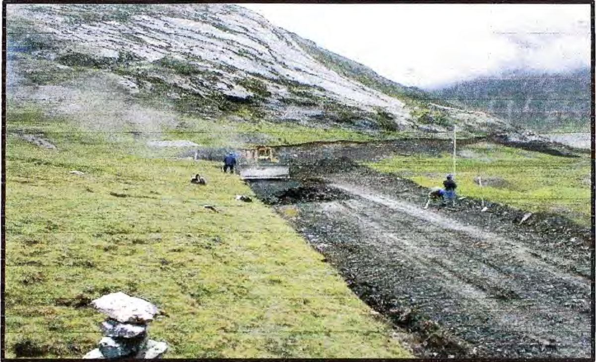
FOTO N° 27 TRABAJOS DE PREPARACIÓN DE PLATAFORMA PARA LA EXCAVACIÓN DEL CANAL DE DERIVACIÓN.
