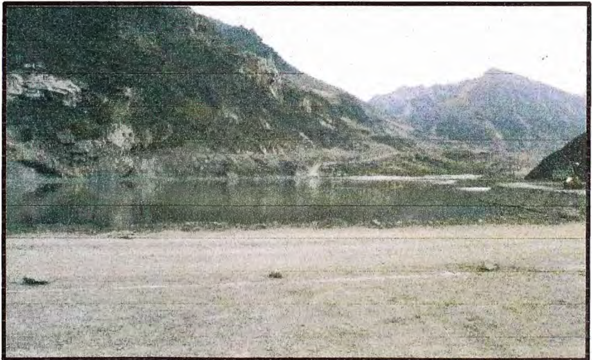
FOTO N° 6 : PRESA DE RELAVES ANDAYCHAGUA. NÓTESE EL NIVEL DEL RELAVE Y EL AGUA, CERCANO A LA CRESTA DE LA PRESA. (AL W)
