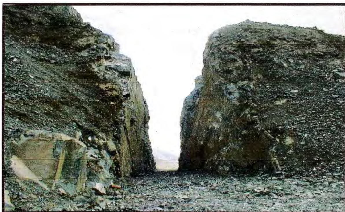
FOTO N° 16 : DETALLE OBRAS DE RECRECIMIENTO Y REFORZAMIENTO PRESA DE RELAVES DE ANDAYCHAGUA – CORTE PARA NUEVO ALVIADERO.
