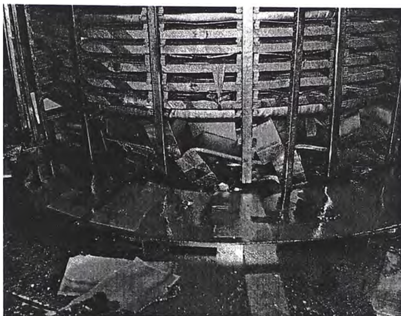
Fig. 3.26 Transformador con Devanado Fallado
