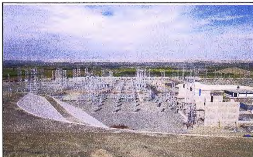
Fig. 3.2 Vista panorámica de la S.E. Chimbote Nueva 500 kV
