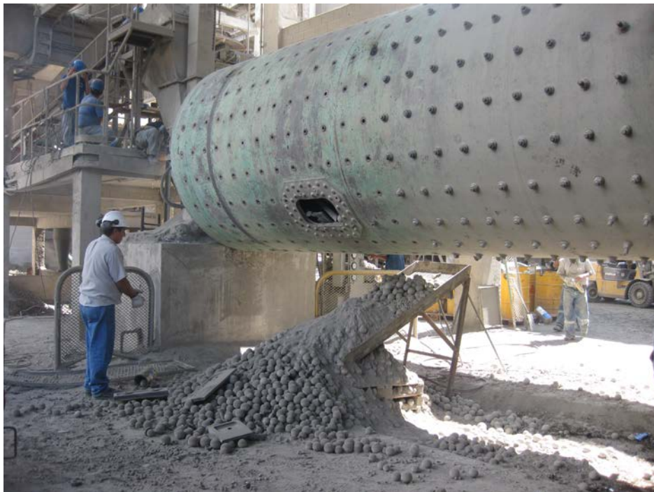
Figura 5.5: Vista exterior de un Molino de Crudo / Cemento
