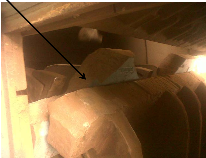
Figura 5.4: Barra Batidora instalada
