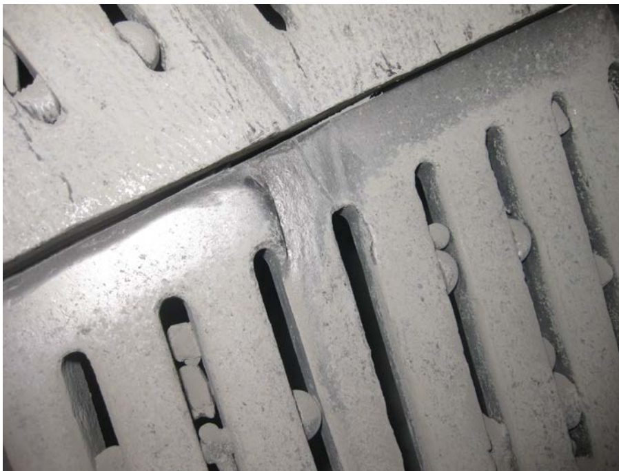
Fig. 5.12: Placas de Pared Intermedia con fisura
