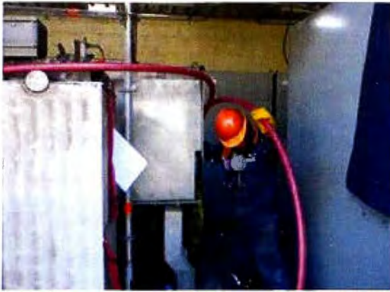
Fig. 4.17 Cableado en transformadores
