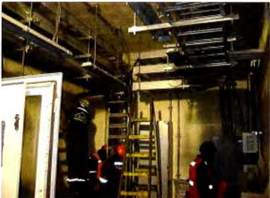
Fig. 4.21 Cableado en sala de control
