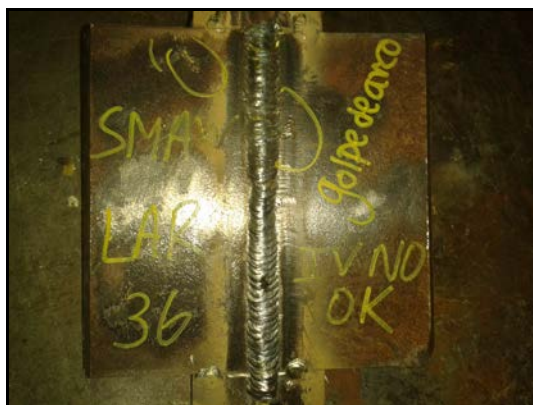
Figura 2.41: Defectos - Soldador LAP, golpe de arco
