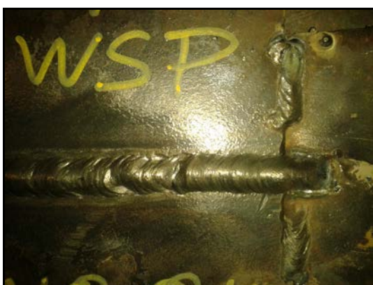
Figura 2.40: Defectos - Soldador WSP, acabado irregular – parte2
