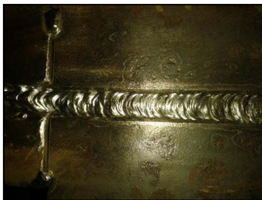
Figura 2.15: Acabado aceptado visualmente – parte3
