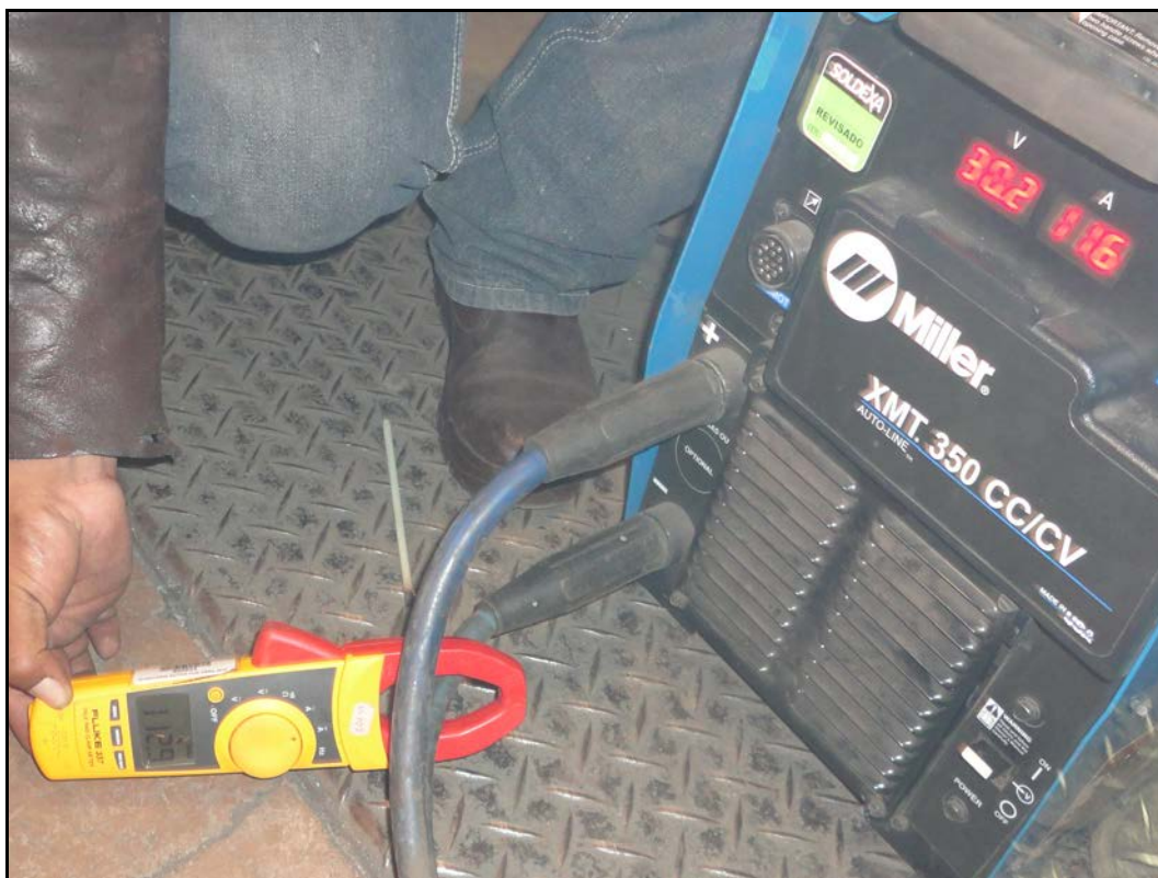
Figura 2.19: Verificación del amperaje de la fuente de poder
