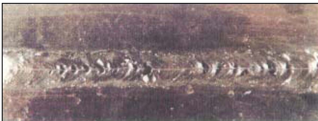
Figura 1.7: Discontinuidades - Fisura longitudinal (fuente, Welding Inspection Technology – 5ta edición)
