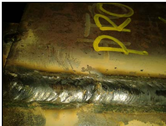
Figura 2.36: Defectos - Soldador PRO malos empalmes – parte2
