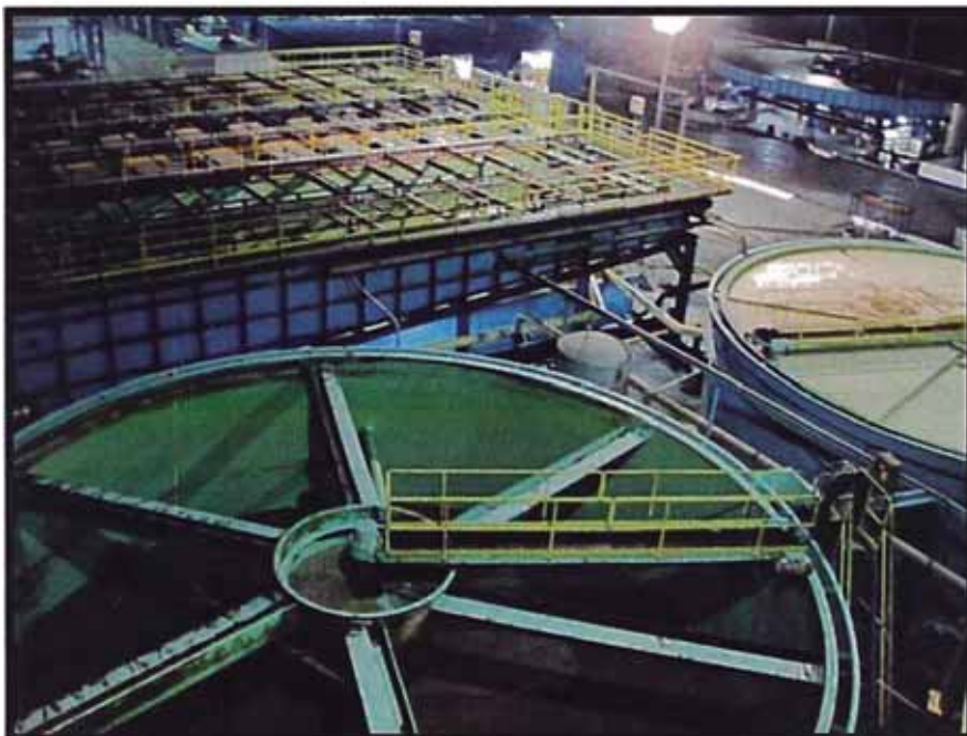
Figura 17: Vista Trampa de Grasas y Celda de Flotación por Aire Disuelto
