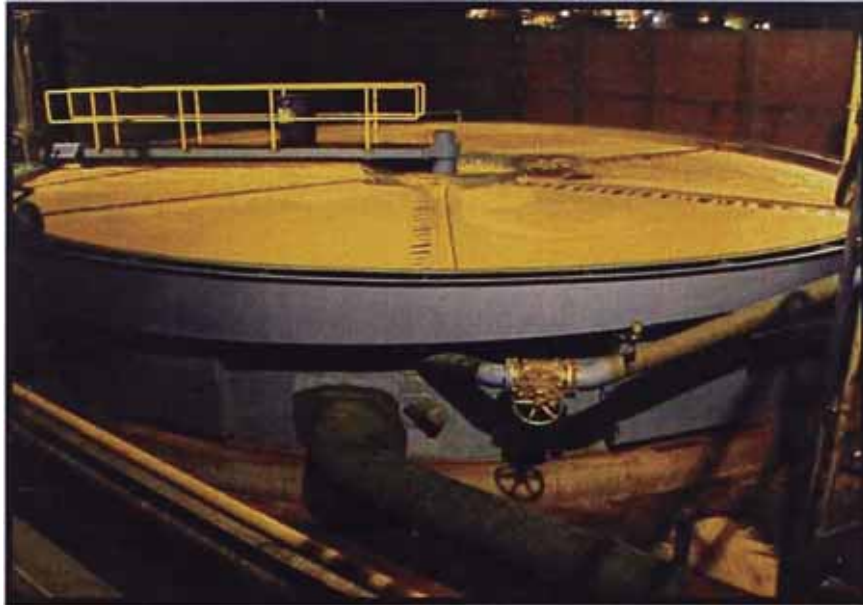
Figura 16: Celda de Flotación por Aire Disuelto
