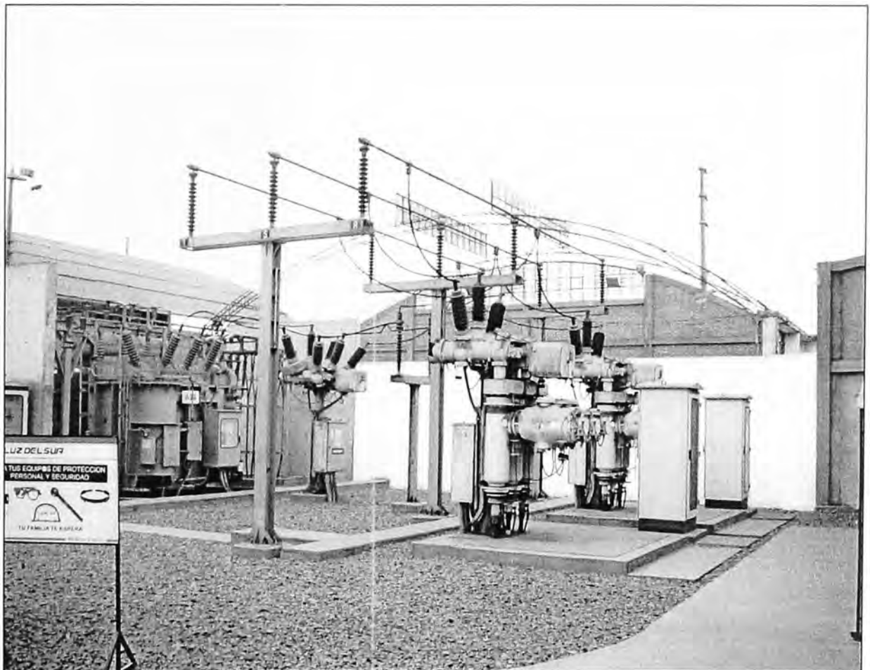
PATIO DE LLAVES COMPUESTO POR TRES BAHIAS 60kV EQUIPADAS CON MODULOS COMPACTOS PASS M00 (01 PARA TRANSFORMADOR Y DOS DE LINEA) – NOTESE QUE EL SISTEMA DE BARRAS EMPLEA BARRAS RÍGIDAS TUBULARES
