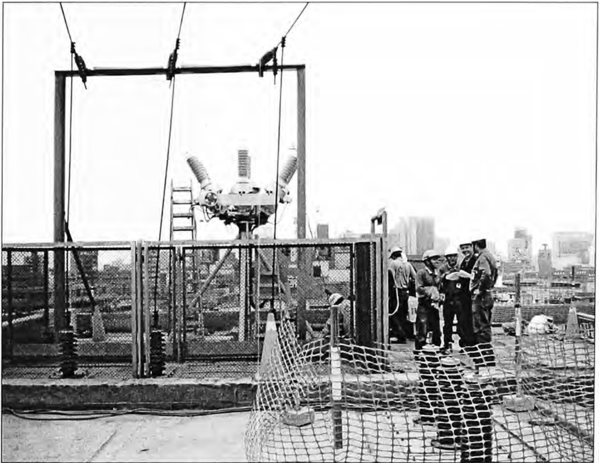
EQUIPO DE MANIOBRA 60kV (TIPO PASS M00) INSTALADO EN EL TECHO DE UNA SUBESTACION TIPO EDIFICIO
