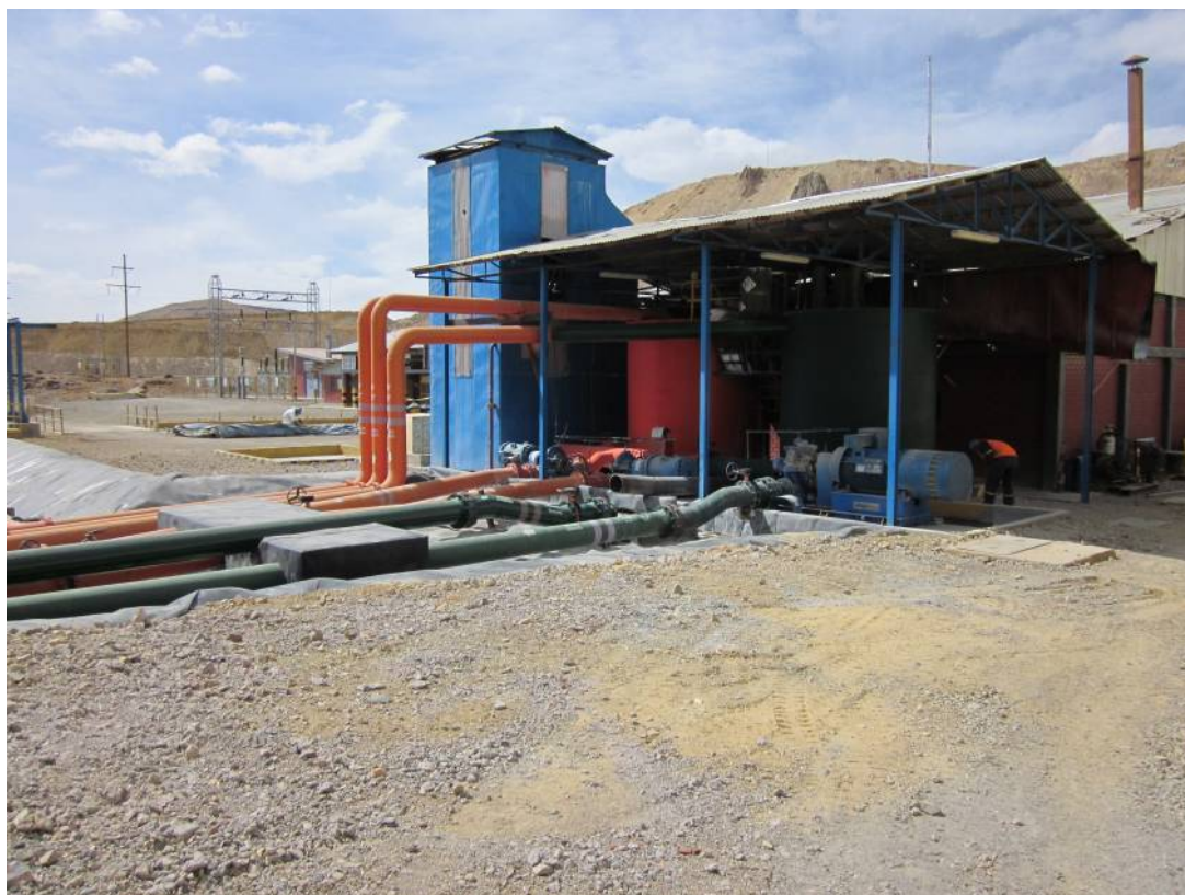
Figura N° 2.38 Sistema de Bombeo de Soluciones al Pad.
