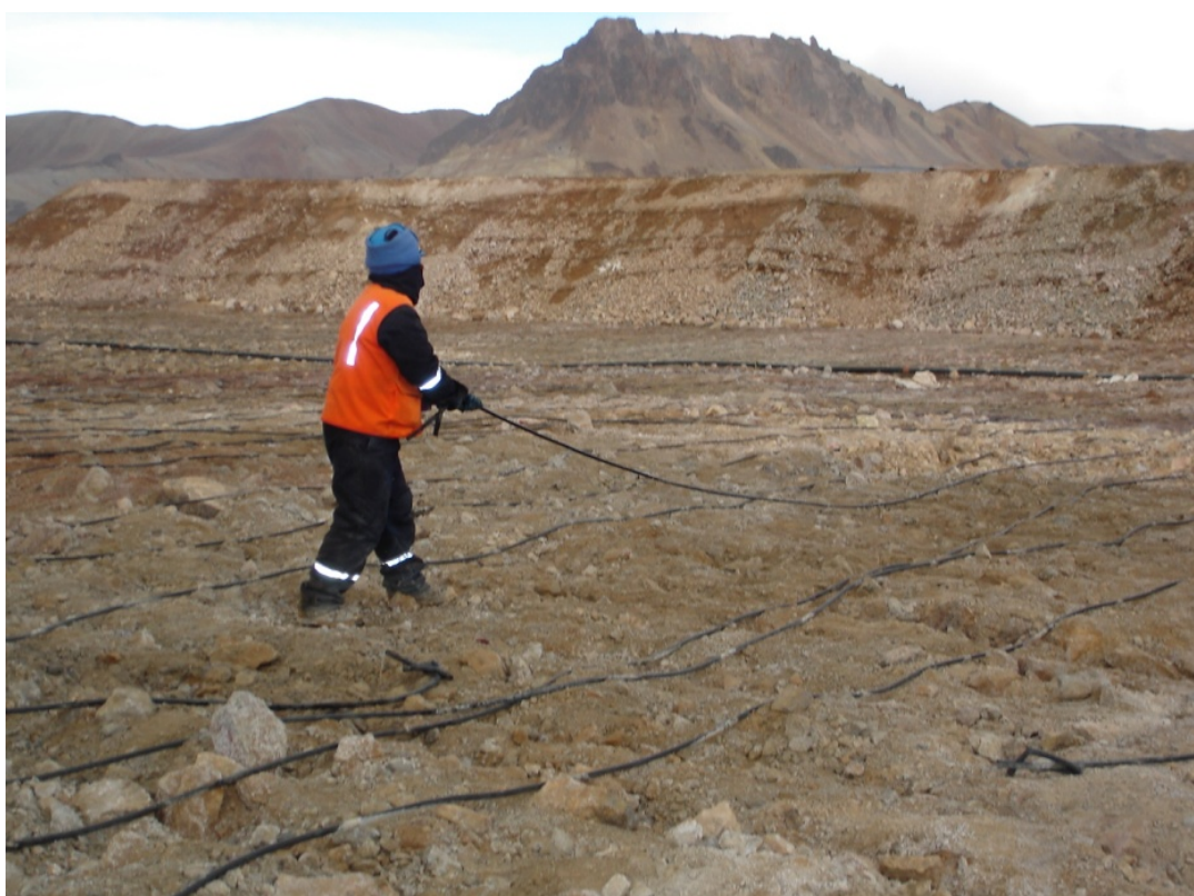
Figura N° 2.24 Purgado de Mangueras.
