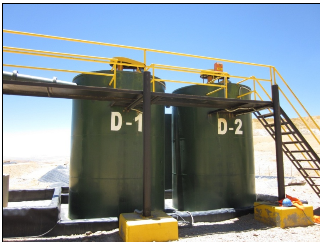
Figura N° 2.41 Tanques para el proceso de destrucción del Cianuro.
