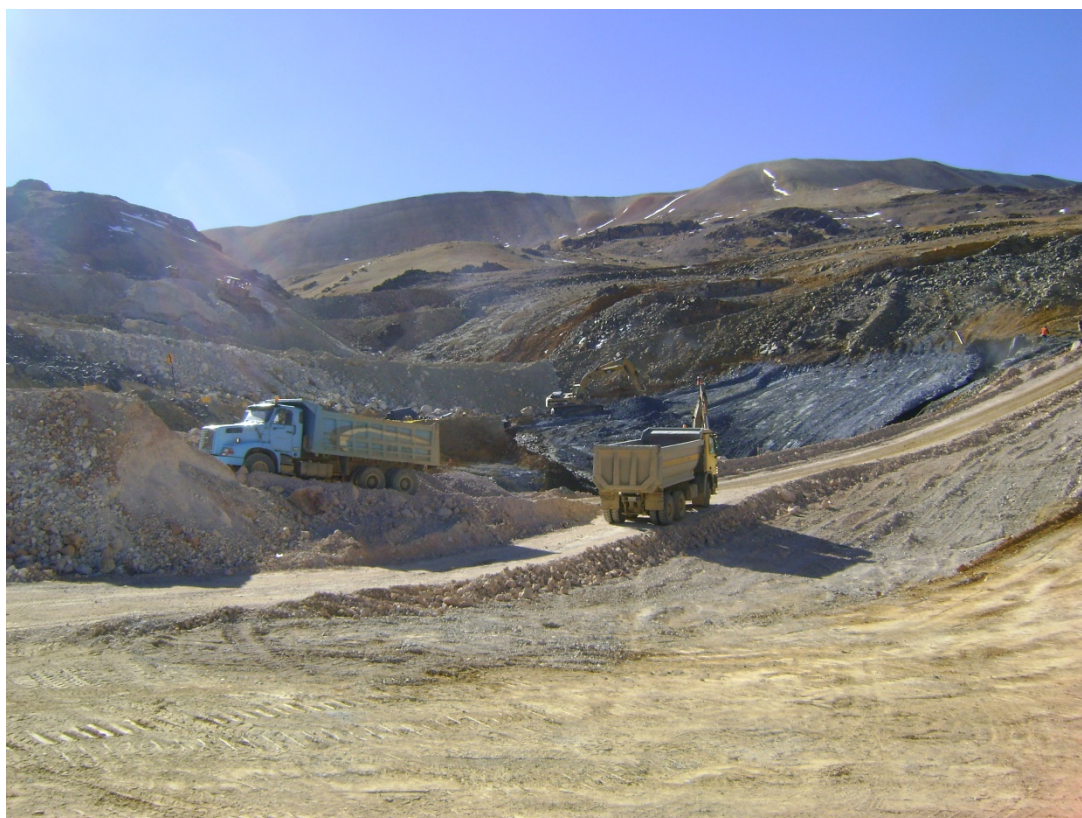
Figura N° 2.6 Limpieza, remoción y eliminación de turba o peat, para luego ser trasladado a botaderos temporales.
