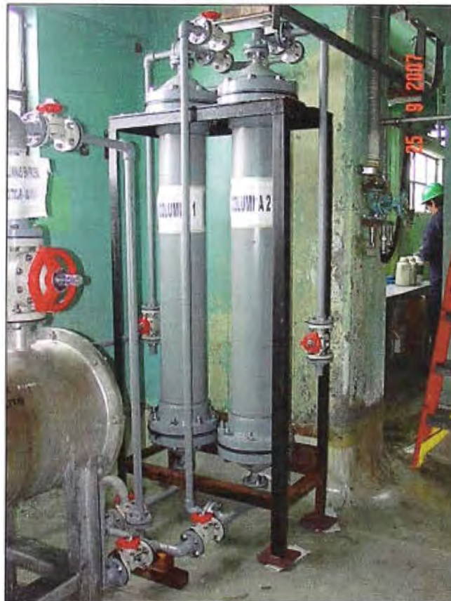
Fig. 3.8 - Montaje experimental a nivel de planta piloto
