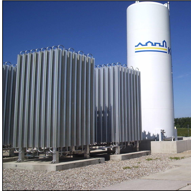
Figura N° 13: Equipos de regasificación de GNL para clientes industriales
