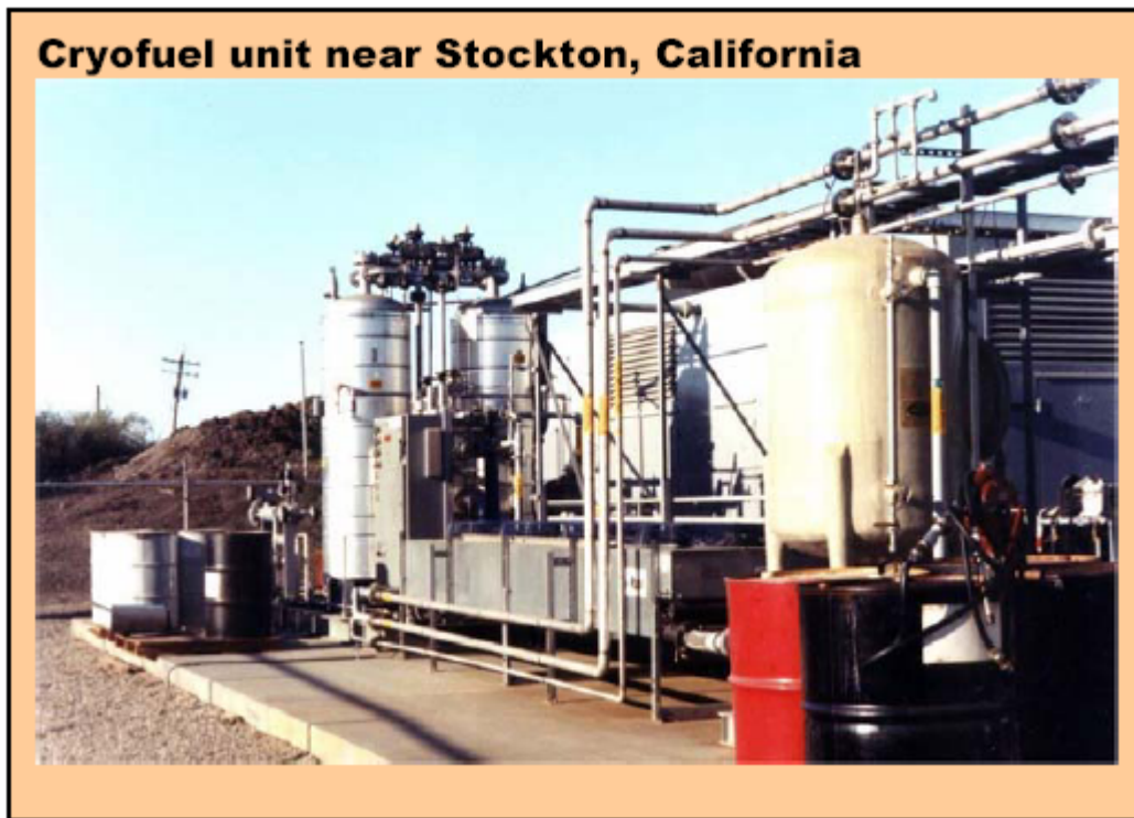
Figura N° 11: Unidad Cryofuel de una Planta de Micro GNL
