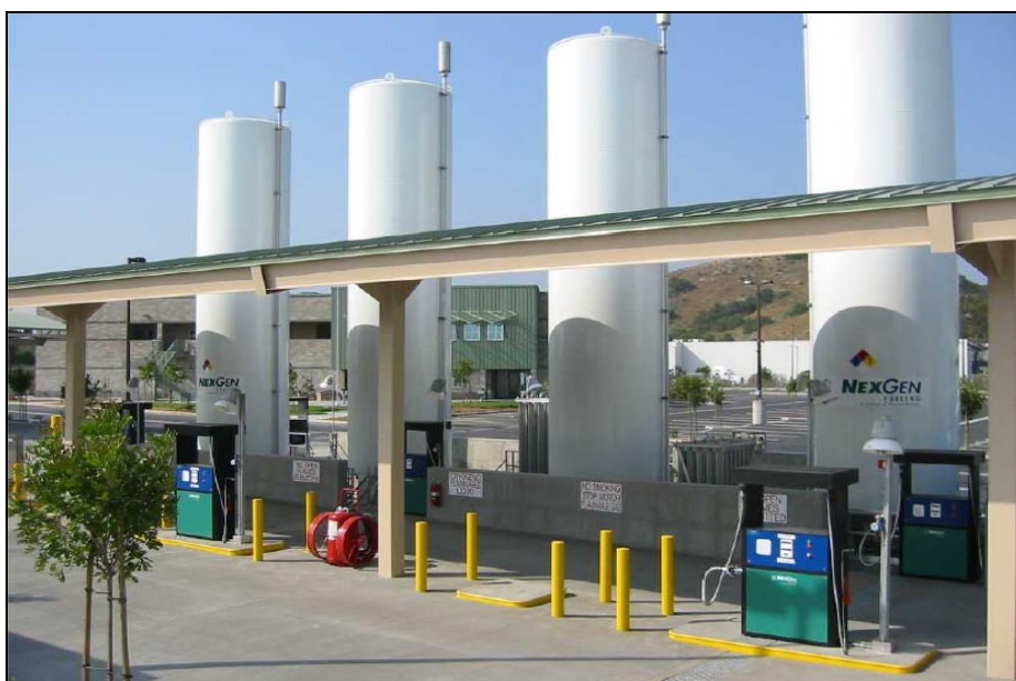
Figura N° 14: Estación de venta de GNL
