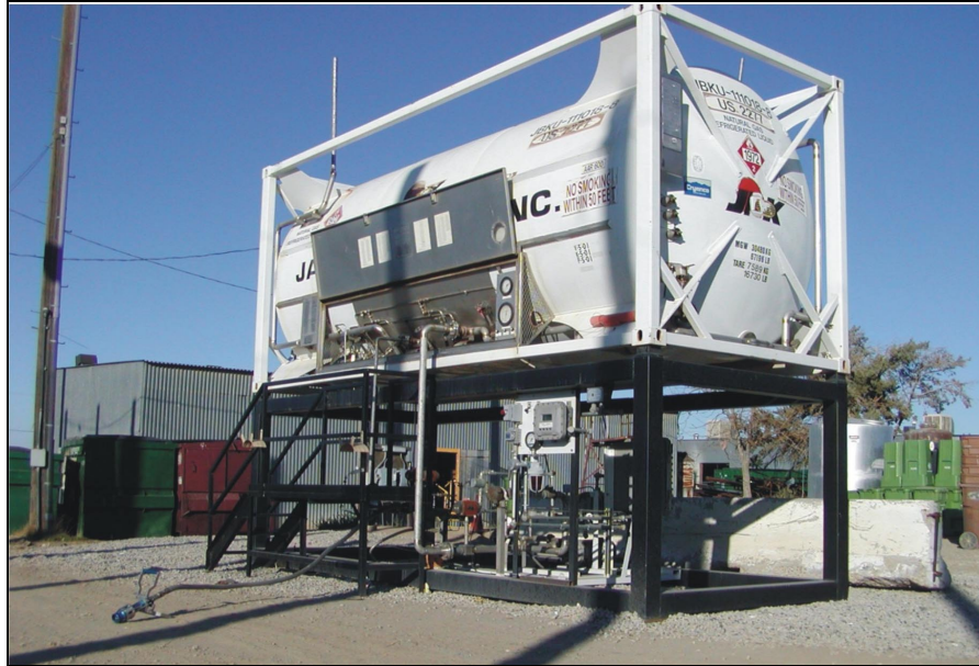
Figura N° 16: Equipo paquetizado de Gas Natural Líquido Comprimido (GNLC), con una capacidad de almacenamiento de 3 000 galones de GNL
