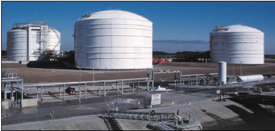
Figura N° 2: Tanques de Almacenamiento de GNL
