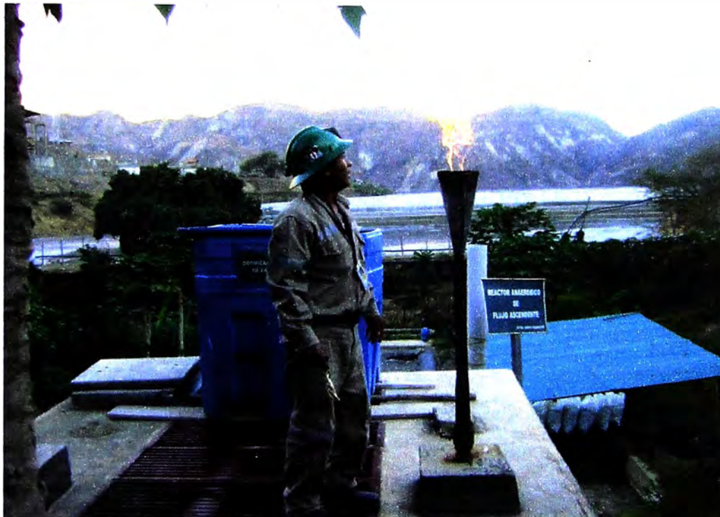
Foto N° 1: La imagen muestra la quema del gas metano formado en el reactor anaerobio de flujo ascendente en la antorcha habilitada.
