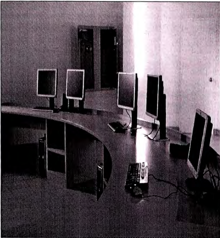
Figura 5. Sala SCADA en la S.E Trujillo Sur – Vista Frontal
