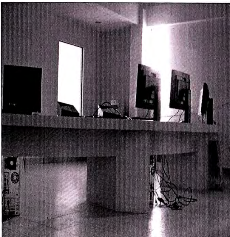
Figura 6. Sala SCADA en la S.E Trujillo Sur – Vista Posterior
