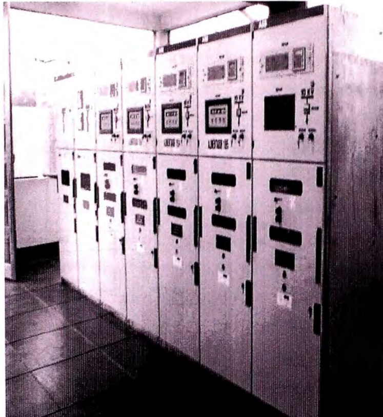
Figura 2.12 Equipos de Medición en los Tableros de Control de una Subestación
