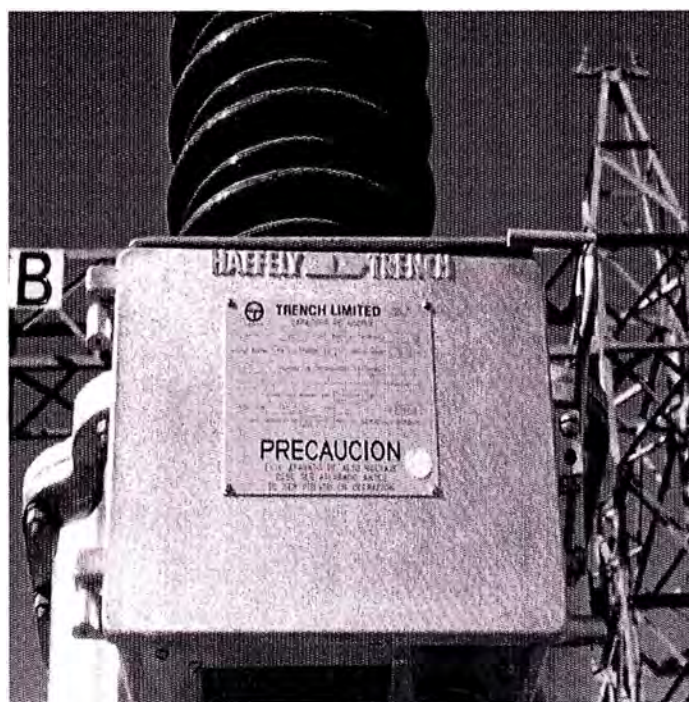
Figura 30. Placa datos de Transformador Capacitivo
