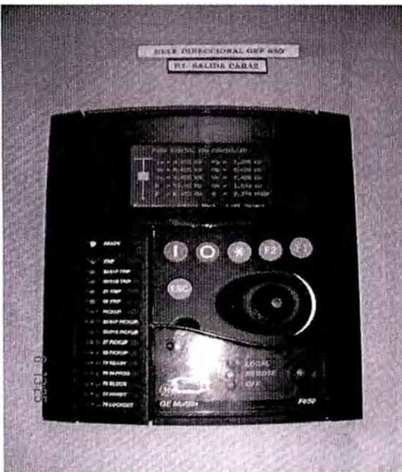
Figura 26. Vista Relé F650
