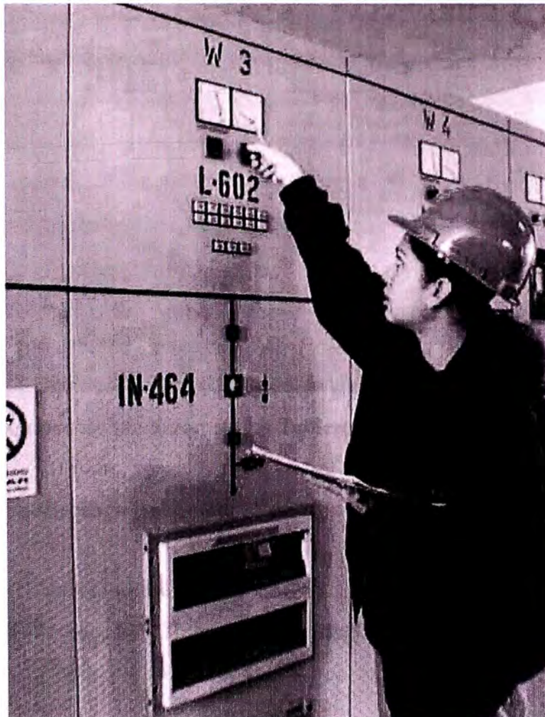
Figura 2.11 Tablero de Control en la Subestación Chimbote
