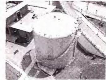
TANQUE DE ALMACENAMIENTO
