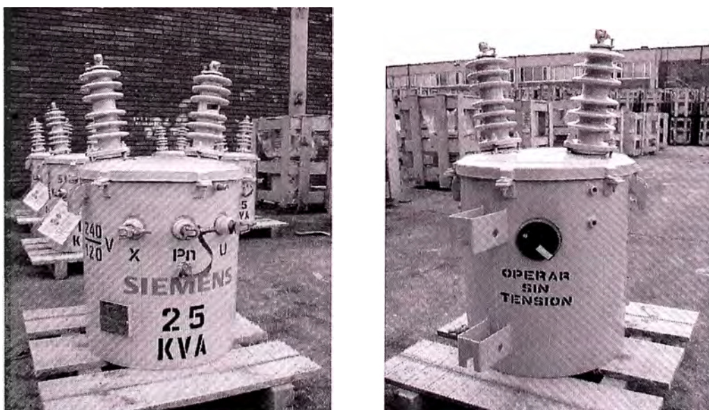
Figura 3.1 Transformadores Monofásicos convencionales
