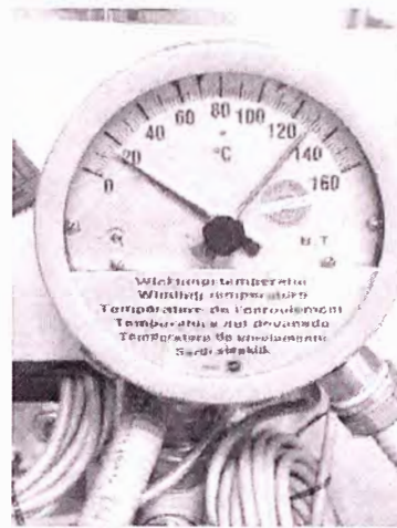
Windings temperature Temperatura de los devanados
