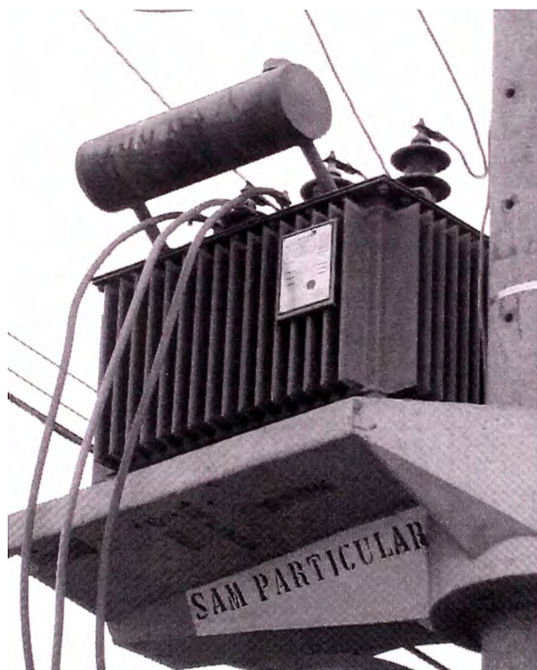
Figura 4.7 Transformador de cuba con superficie corrugada
