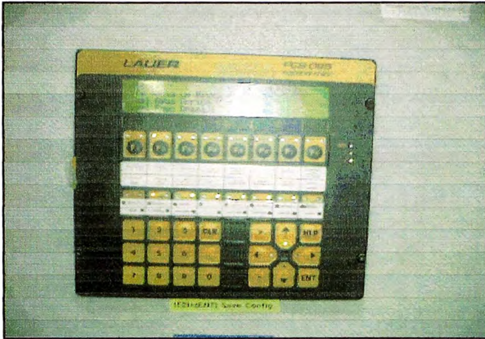
FIG. 5.6 PANEL DE INTERFASE DEL REGULADOR DE VELOCIDAD
