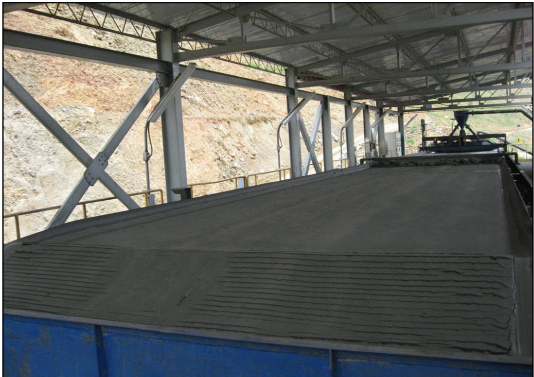
Figura N° 3.7: Filtro banda horizontal
