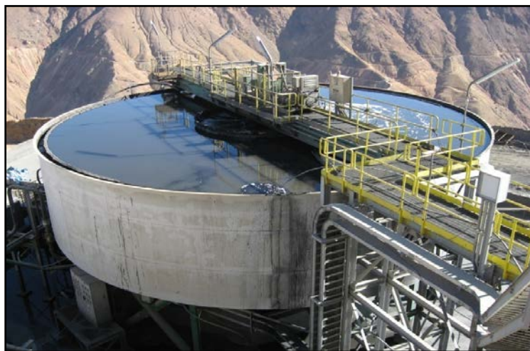
Figura N° 2.1: Espesador de 8 m
