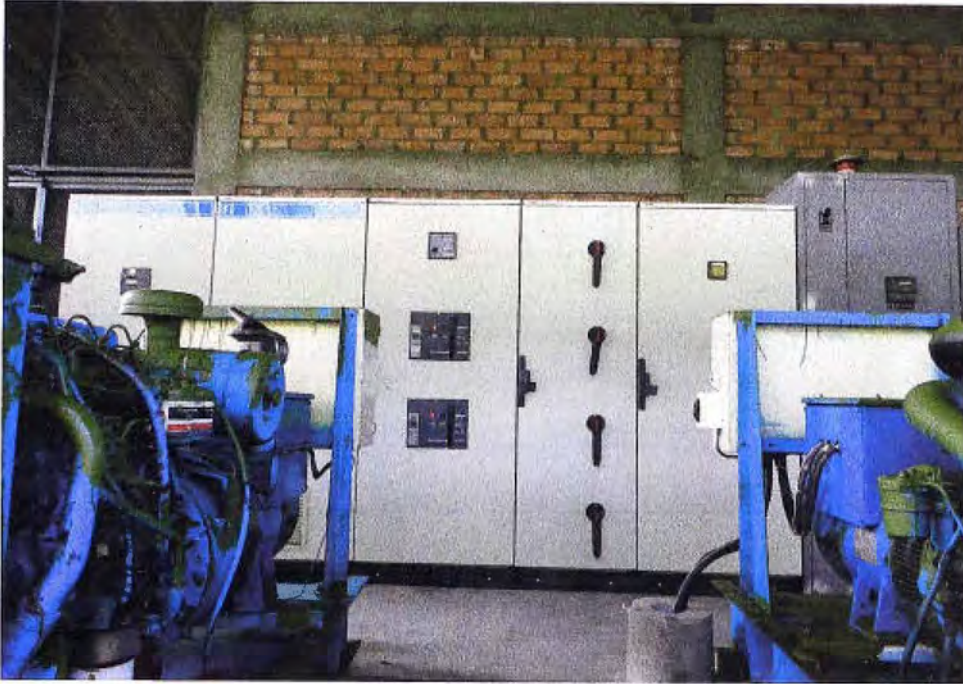
Foto del tablero de la planta
