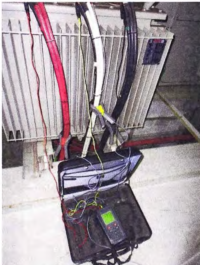
Foto del Transformador de la planta
