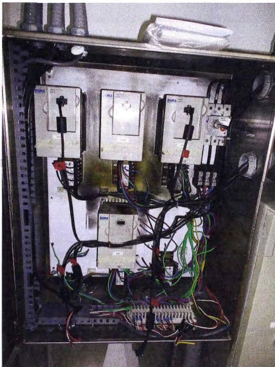
Foto de dos Variadores de velocidad deteriorados por fallas en la planta
