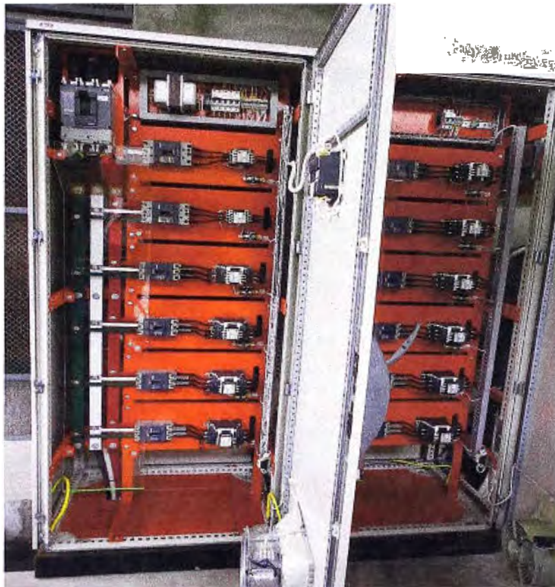
Foto del banco de condensadores de la planta
