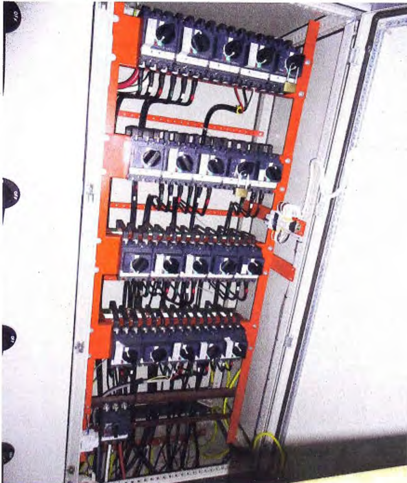
Foto del banco de condensadores de la planta
