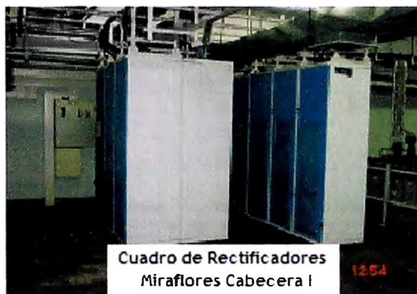
Figura 2.11: Respaldo de Rectificadores en los ambientes de la Central Miraflores
