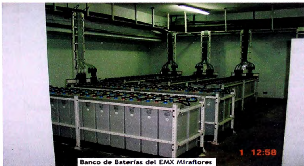
Figura 2.17: Banco de baterías del Nodo Celular de Miraflores
