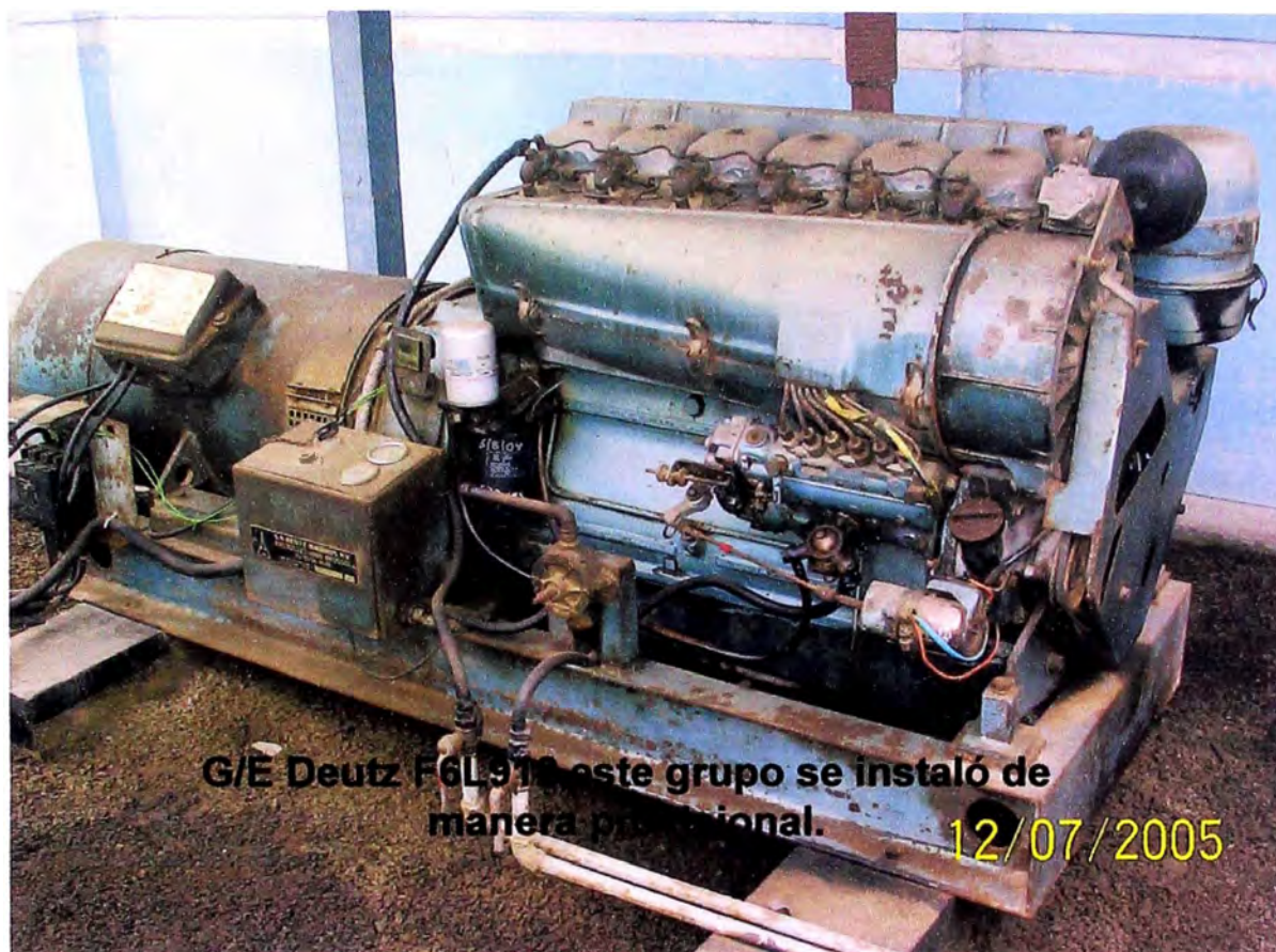
Figura A.9: Instalación provisional de Grupo Electrónico
