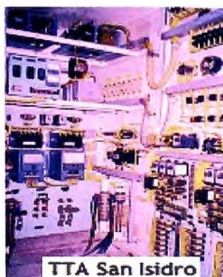
Figura 2.8: Tablero de Transferencia Automático ubicado en los ambientes de San Isidro
