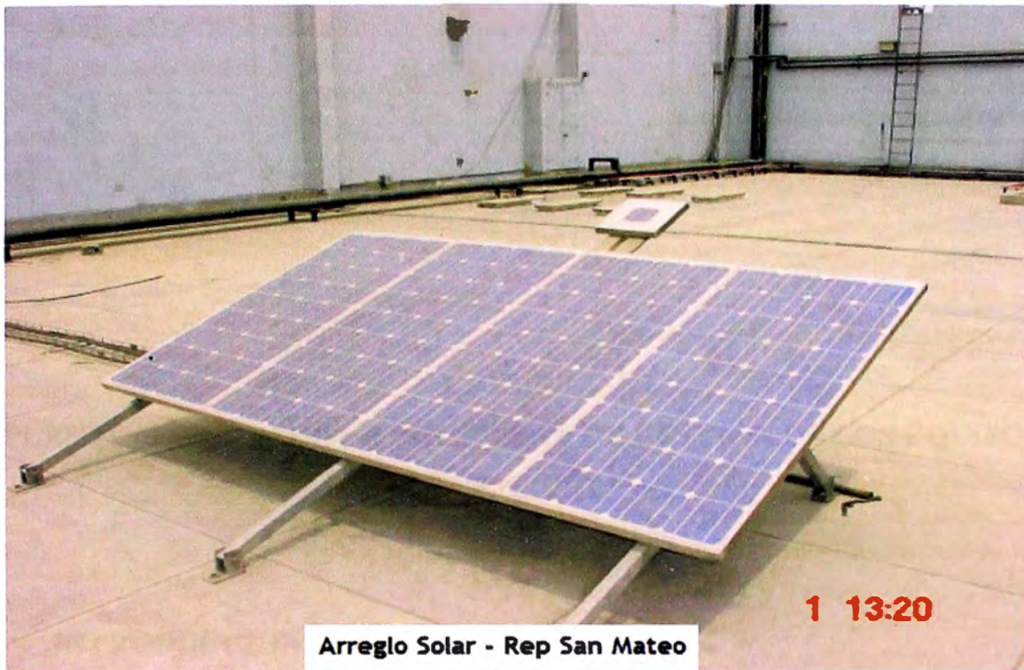
Figura 2.25: Arreglo Solar del Repetidor San Mateo
