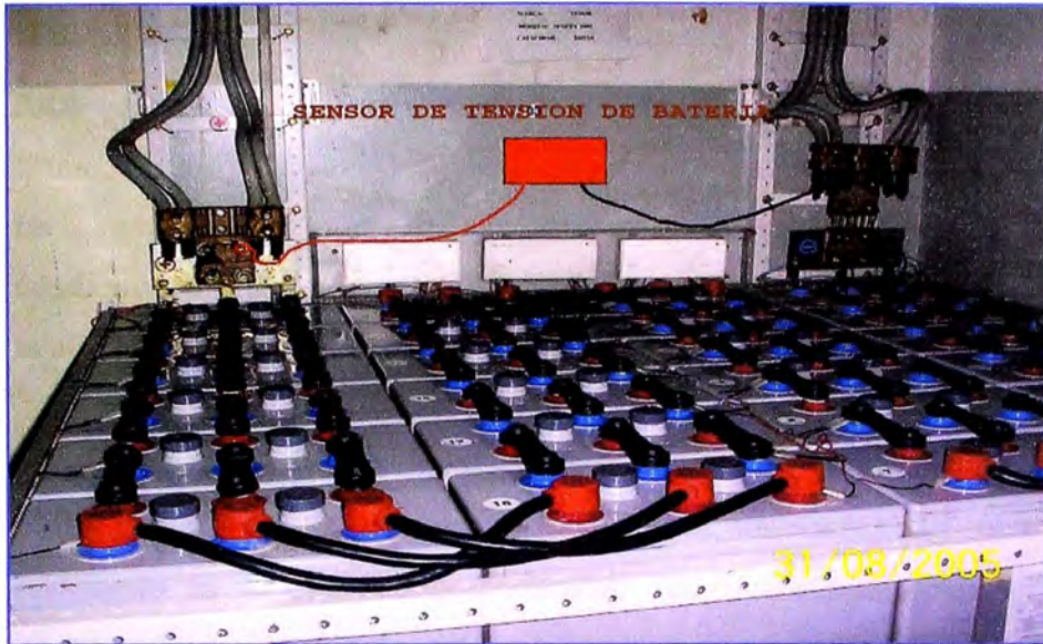
Figura 5.10 Ubicación del Sensor de Tensión Crítica del Banco de Baterías
