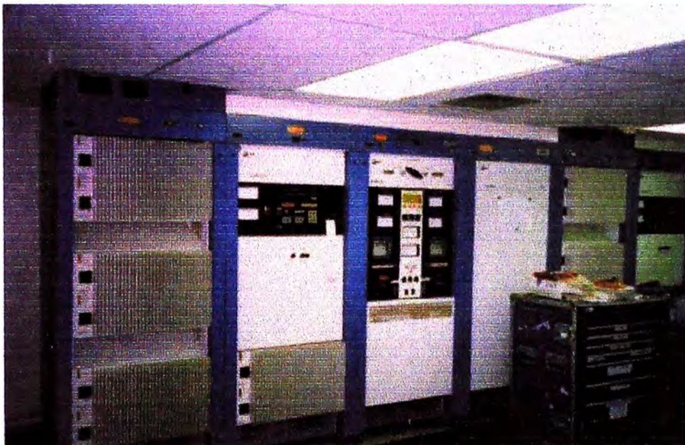
Fig. 2.27. El PFE en la Sala de Transmisiones
