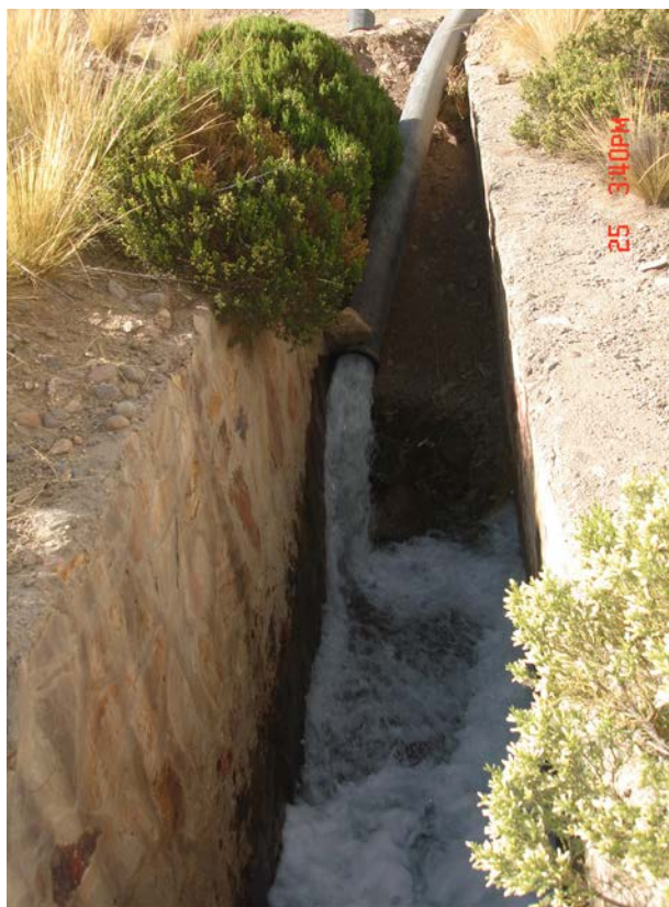
Figura 5.7. Descarga de de agua tratada (Resultados del monitoreo bajo los LMP)
