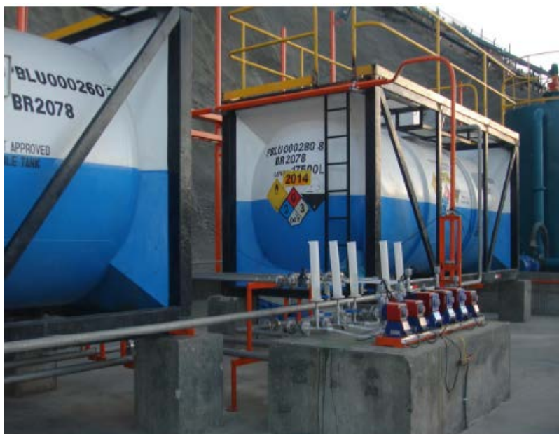
Figura. 4.2. Isotankes para almacenamiento de peróxido de hidrogeno
