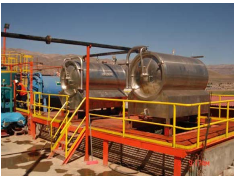
Figura. 4.4. Clarificadores de discos de 100 m 3 de capacidad
