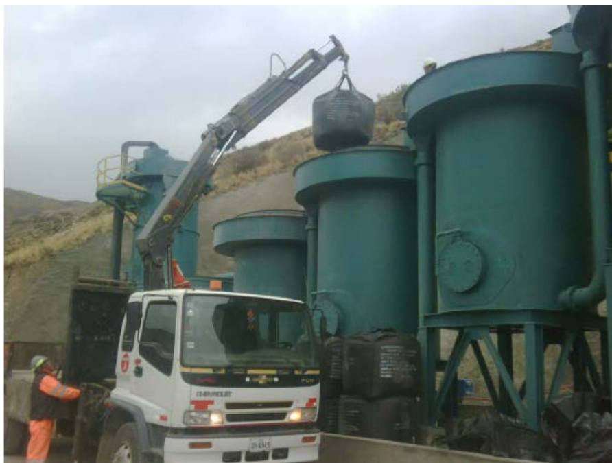
Figura. 6.3. Llenado de carbón para recuperación de Au y Ag de del agua de la Relavera
