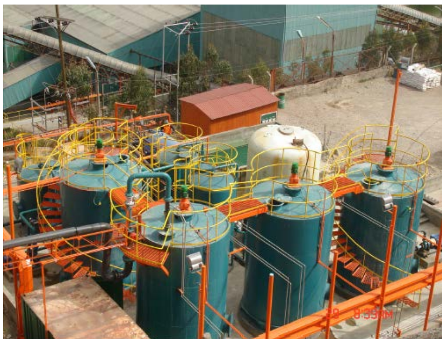
Figura. 4.3. Tanques de Reacción
