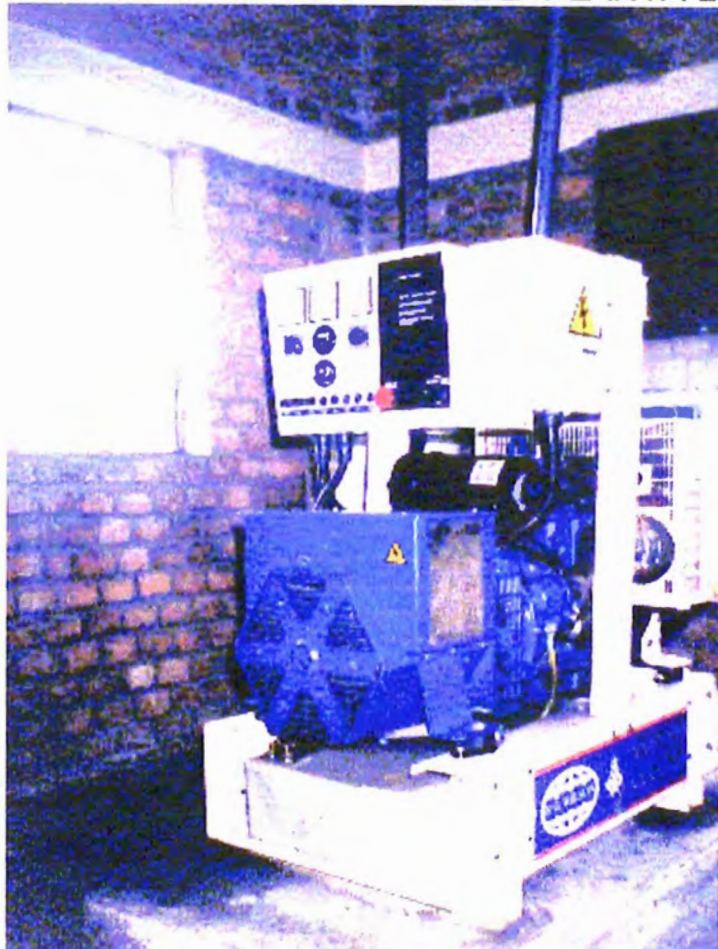
GRUPO ELECTRÓGENO -PLANTA LECHERA
