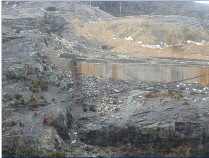
Figura N°3.2 Se observa la relavera de la Compañía Corporación Minera Ananea sin canal de coronación.
