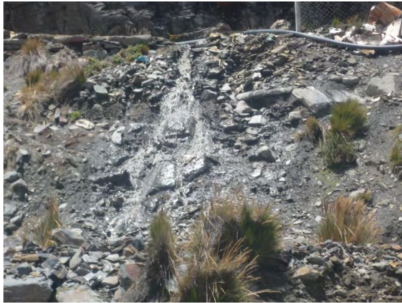
Figura N°2.9 Desagüe del pueblo de La Rinconada mal dispuesto que drena a la naciente del río “Ramis”.
