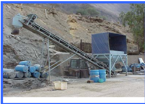
PLANTA DE CONCRETO
