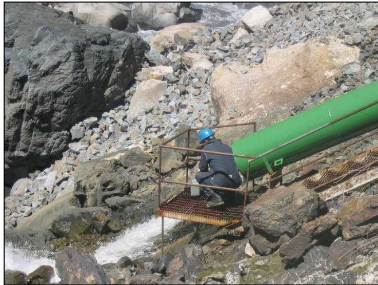
Imagen 6.6: Descarga de las aguas de mina tratadas al río Mantaro.
