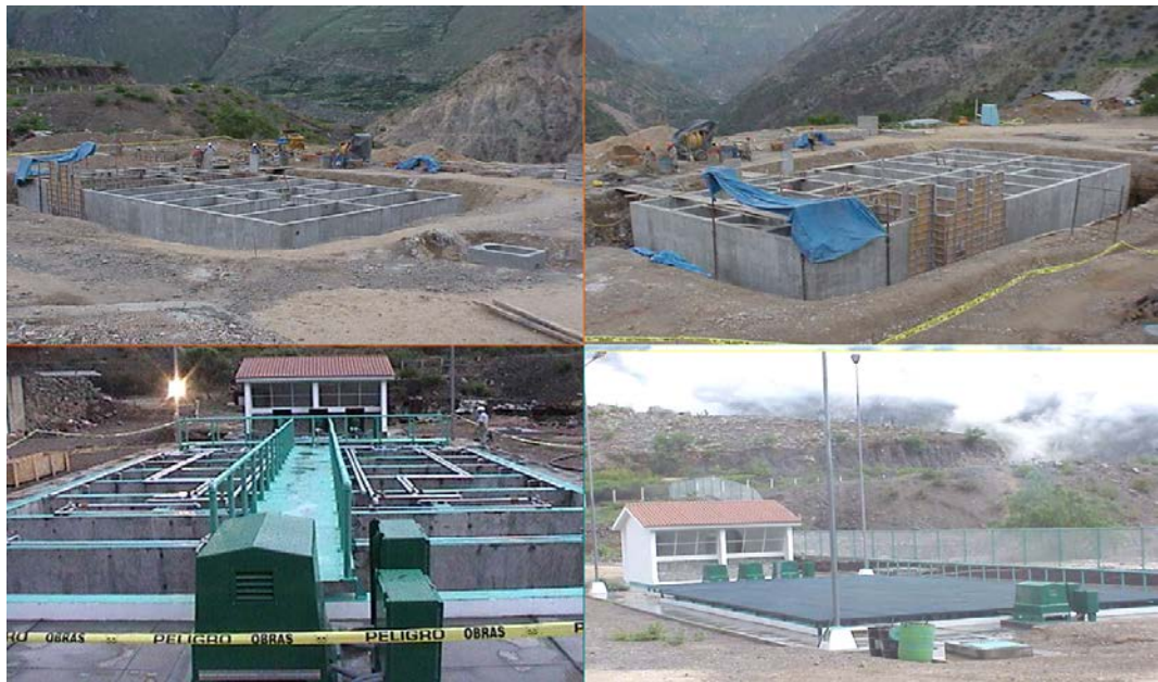
Imagen 6.4: PLANTA DE TRATAMIENTO DE AGUAS SERVIDAS.
