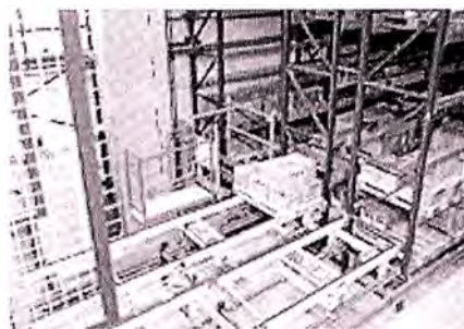
Figura 4.8 Los almacenes de estantes elevados - SafetyBUS p
