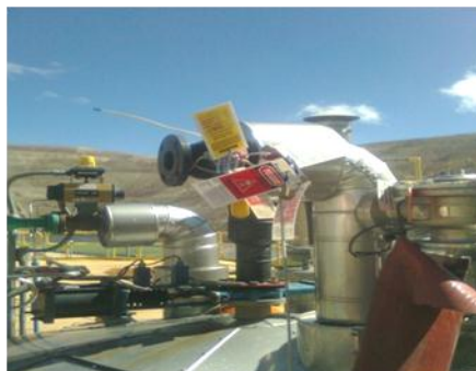
Fig. 2.2: Bloqueo de Válvulas
