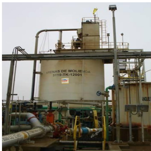
Fig. 1.9: Bombeo de Arenas de Molienda
