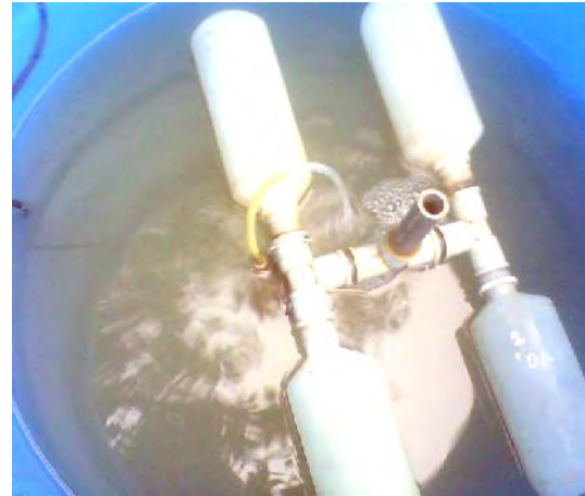
2. Interior de la unidad de almacenamiento
