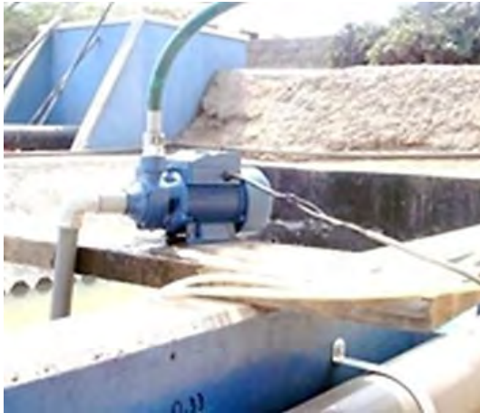
1. Zona de bombeo del efluente del reactor UASB
