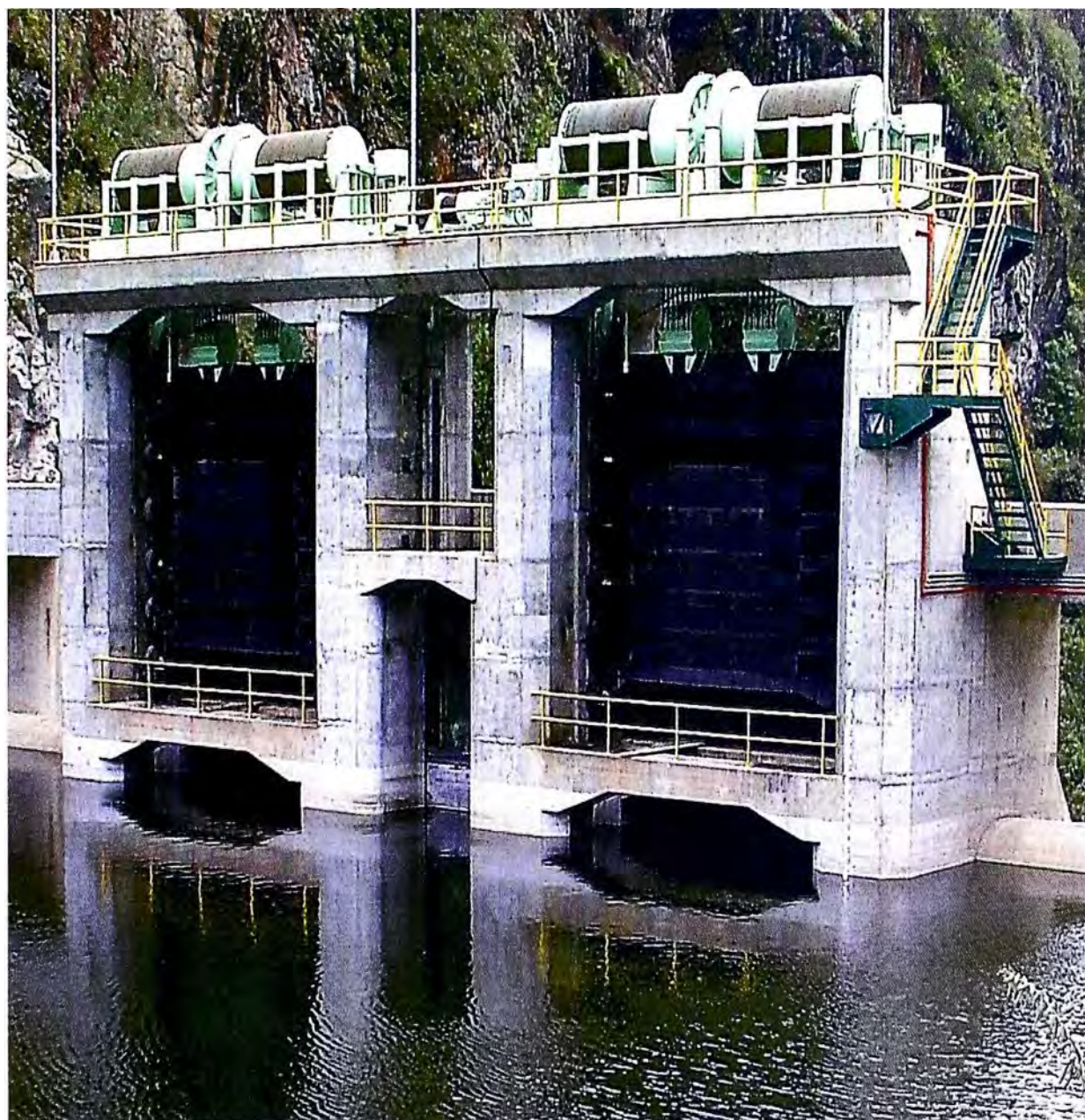
Fig. 2.8 Compuertas deslizantes de mantenimiento de la presa Huallamayo
