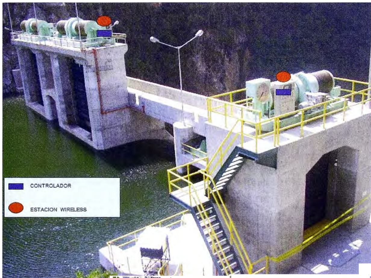
Fig. 4.9 Distribución del Hardware de comunicaciones en presa Huallamayo
