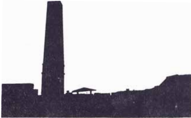
Fig. 5.7. Chimenea de ladrillo de apreciable altura. Obsérvese posible plano de falla.
