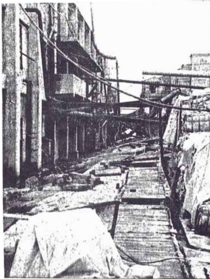
Fig. 3.20. Niigata, 1964. Daños en tubería. Algunos tipos de tuberías en Z, fueron dañadas en las juntas soldadas. Las tuberías apoyadas en columnas se doblaron.
