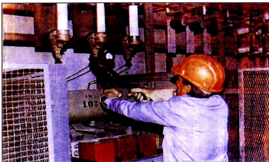
Fig. 5.8: Medición de Corriente Instantánea en el lado de Media Tensión de una Subestación de Distribución
