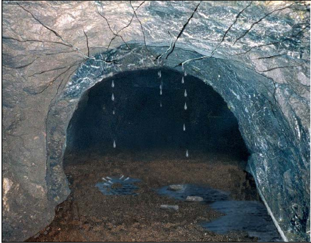
FIGURA 4 EL AGUA PUEDE LUBRICAR LAS FAMILIAS DE DISCONTINUIDADES Y PERMITIR QUE LAS PIEZAS DE ROCAS SE MUEVAN.
