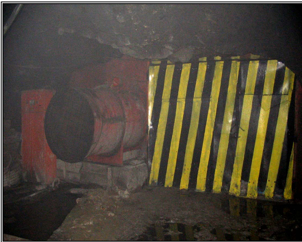
FIGURA 15 PUERTAS DE VENTILACION
