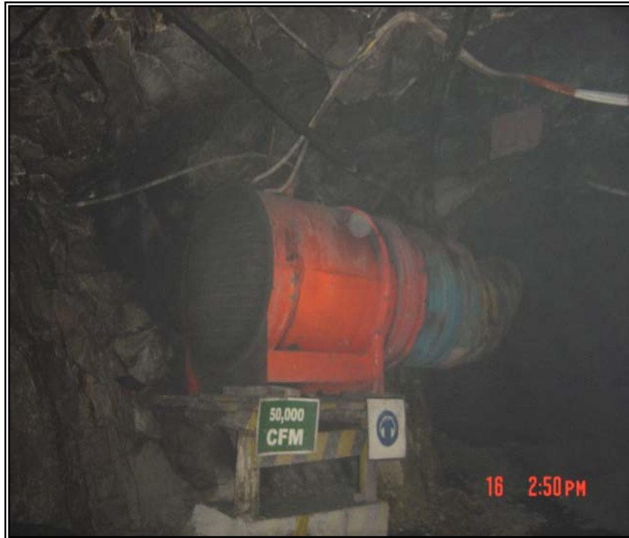
FIGURA 16 VENTILACIÓN SECUNDARIA COMO SE OBSERVA EN LA FOTO 02
