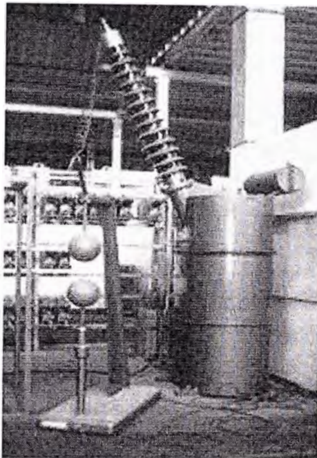
Figura 2.4 Transformador de alimentación para Prueba de Tensión Aplicada
