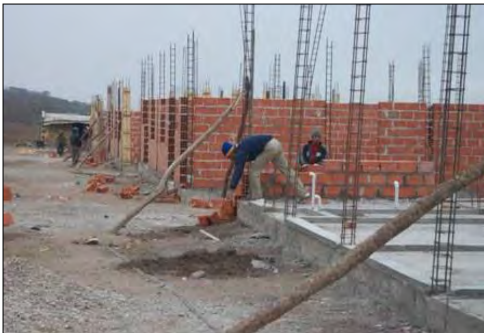
Figura N° 5.2: Muestra la construcción de una vivienda sin realizar los estudios del terreno. Fuente: Web Internet
