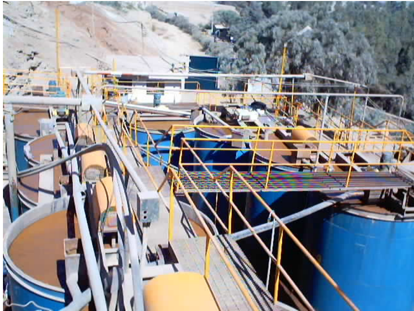
Foto N° 19: Vista de los espesadores
