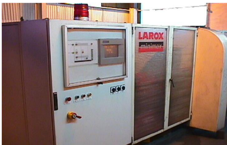
Foto N° 4-30. Filtro Larox para los lodos
