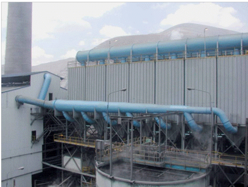
Foto N° 4-12. Vista exterior de los baghouse de encerramiento
