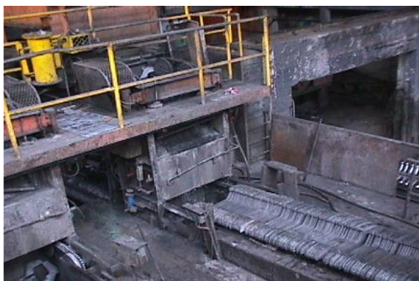
Foto N° 4-23. Maquina lavadora de ánodos corroídos
