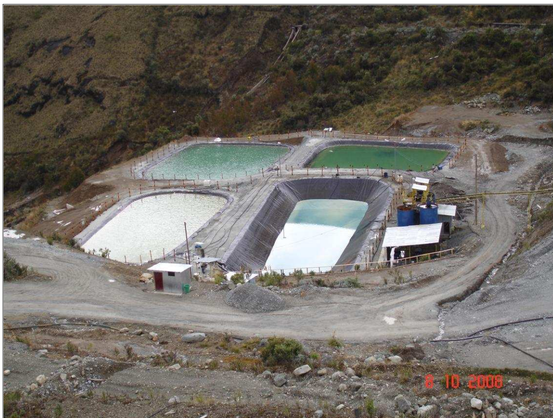
FIGURA 22. Vista panorámica de la planta de Tratamiento de Efluentes.
