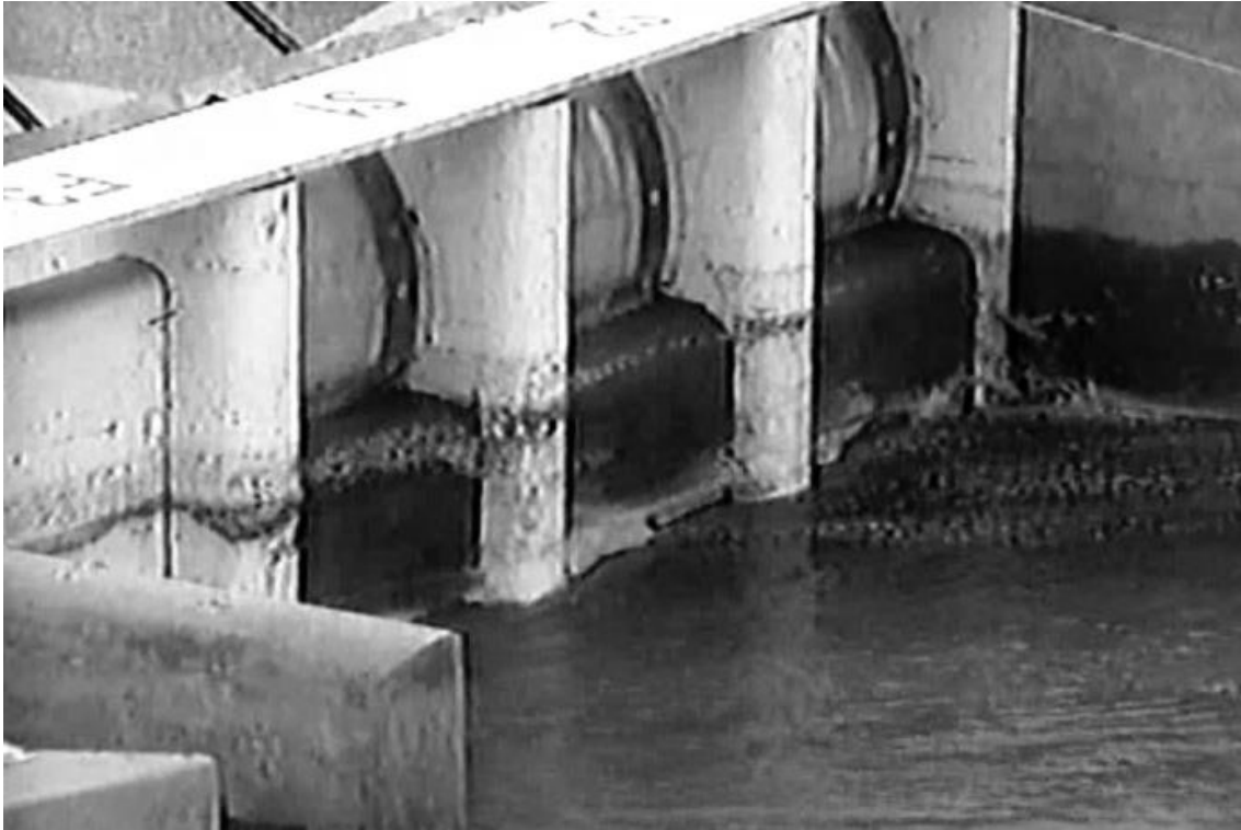
Fotografía 5.7. Erosión producida por el flujo en la descarga inicial
