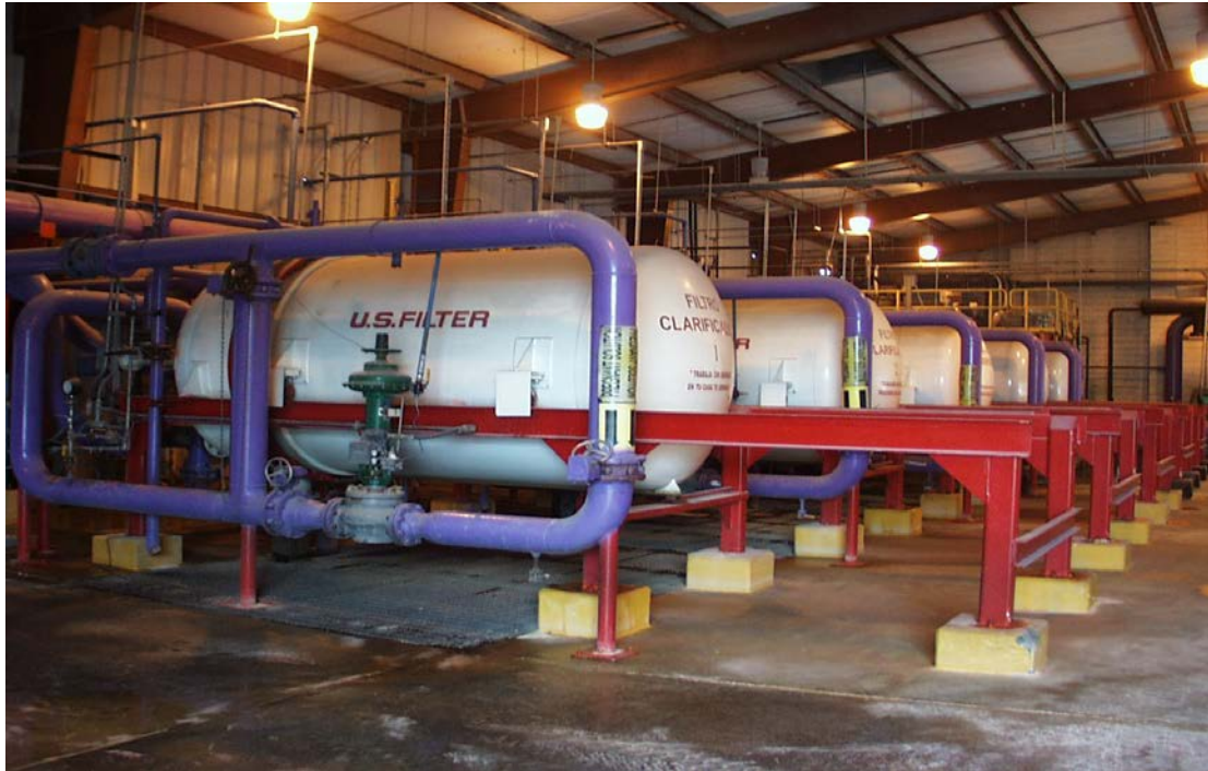
Figura 3.1 Filtros Clarificadores Planta Yanacocha Norte.
