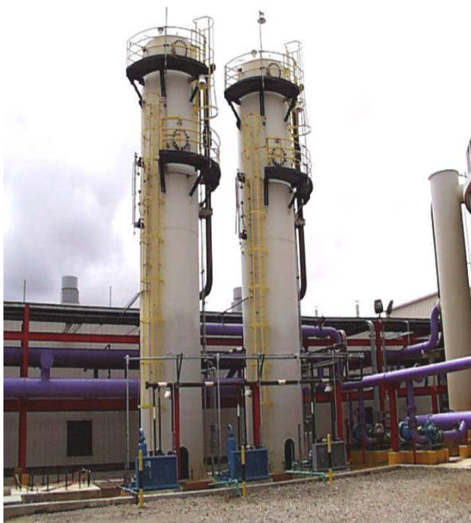
Figura 3.5 Torres de Vacío Planta Yanacocha Norte.
