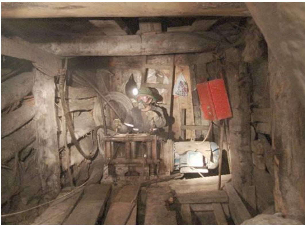
Foto N° 08.- Winche Eléctrico en operación
