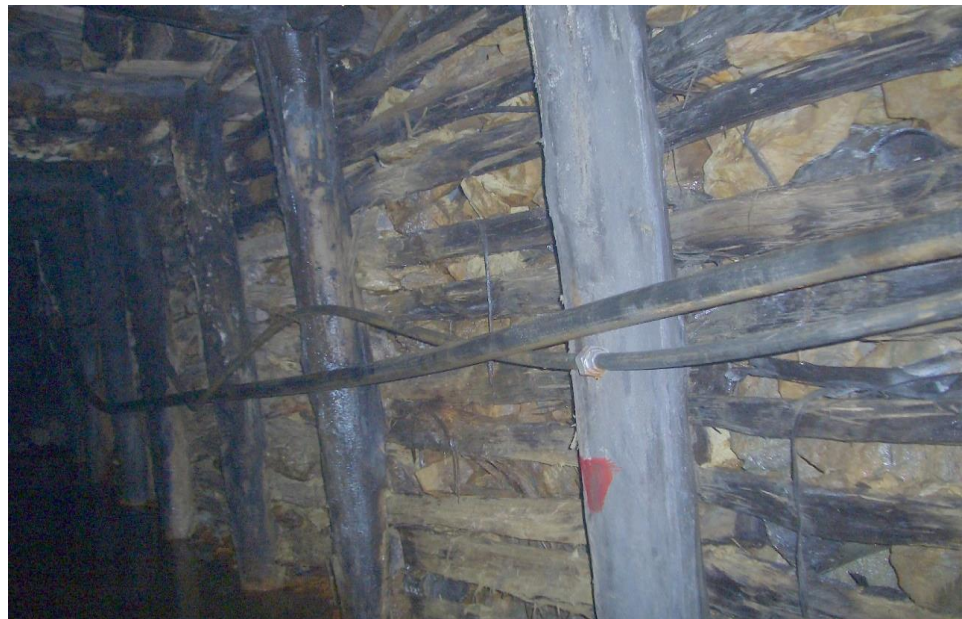
Foto N° 06 .- Correcta Instalación de la Red de distribución de Agua y Aire Comprimido
