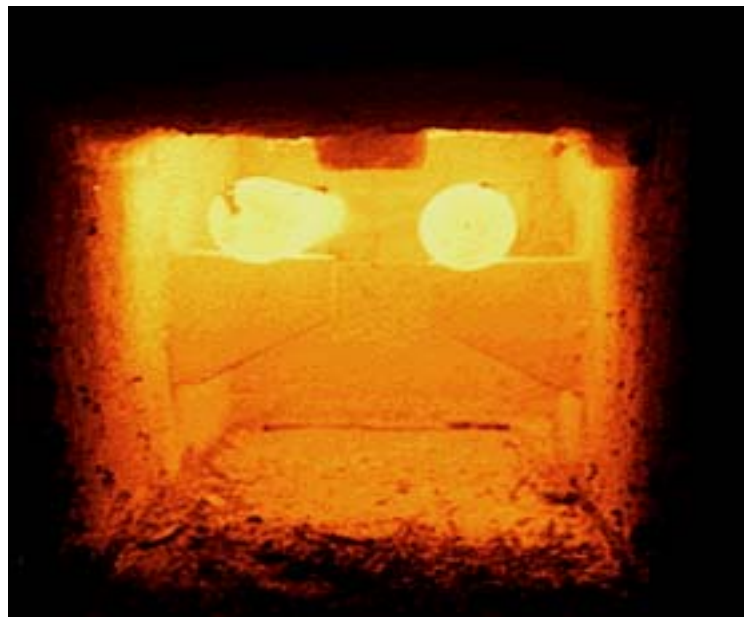
Figura N° 3.5 Quemadores de tubos radiantes
