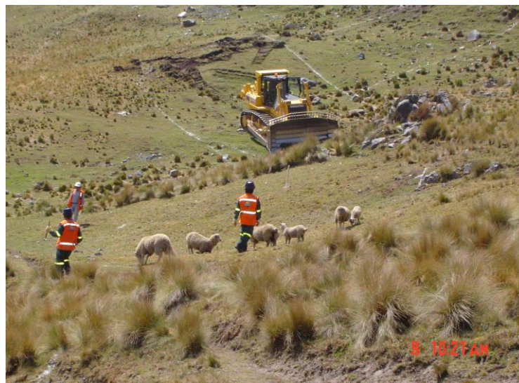
FIGURA 11: PERSONAL DE TOPOGRAFÍA REALIZANDO EL TRAZO DE LA FUTURA VÍA DE ACARREO.
