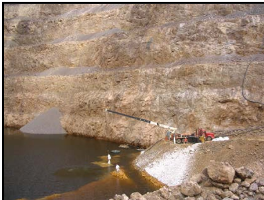
Fig. 8 Drenaje Tajo Tapado
