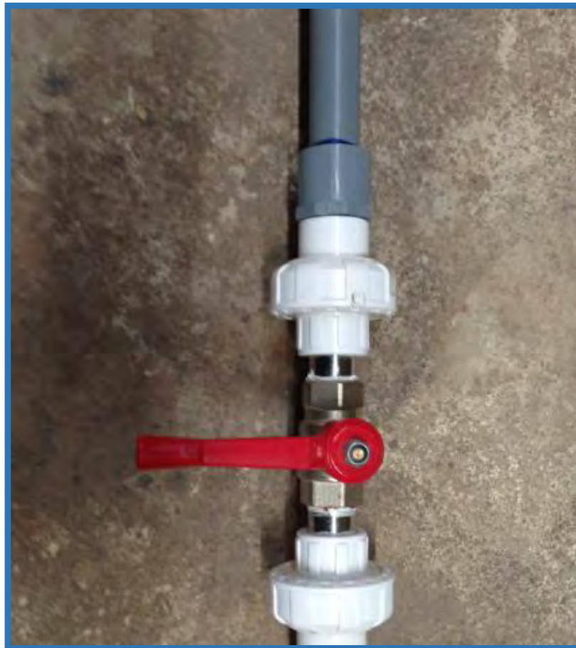
Foto n°83: Válvula esférica PVC.
