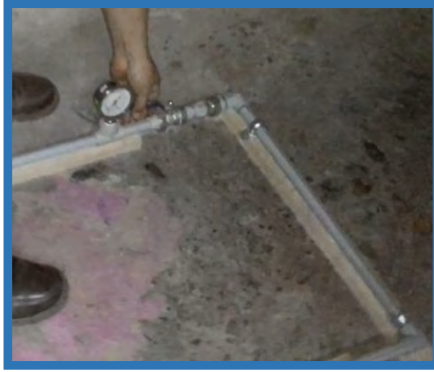
Fotos n°56: Manómetro Punto Final.
