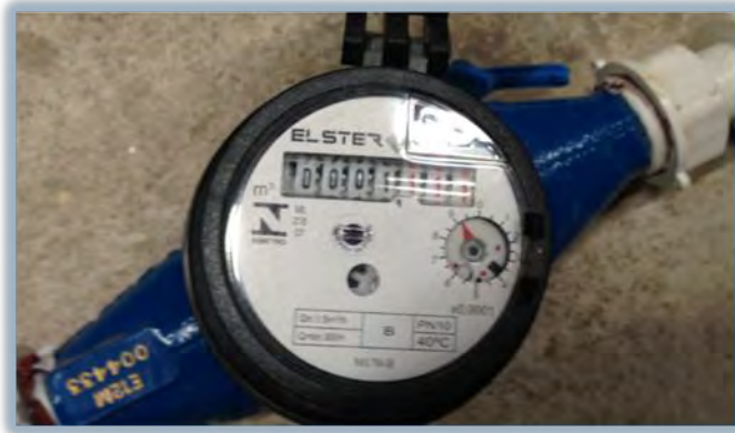
Foto n° 24: Vista Detallada del Medidor de caudal domiciliario.
