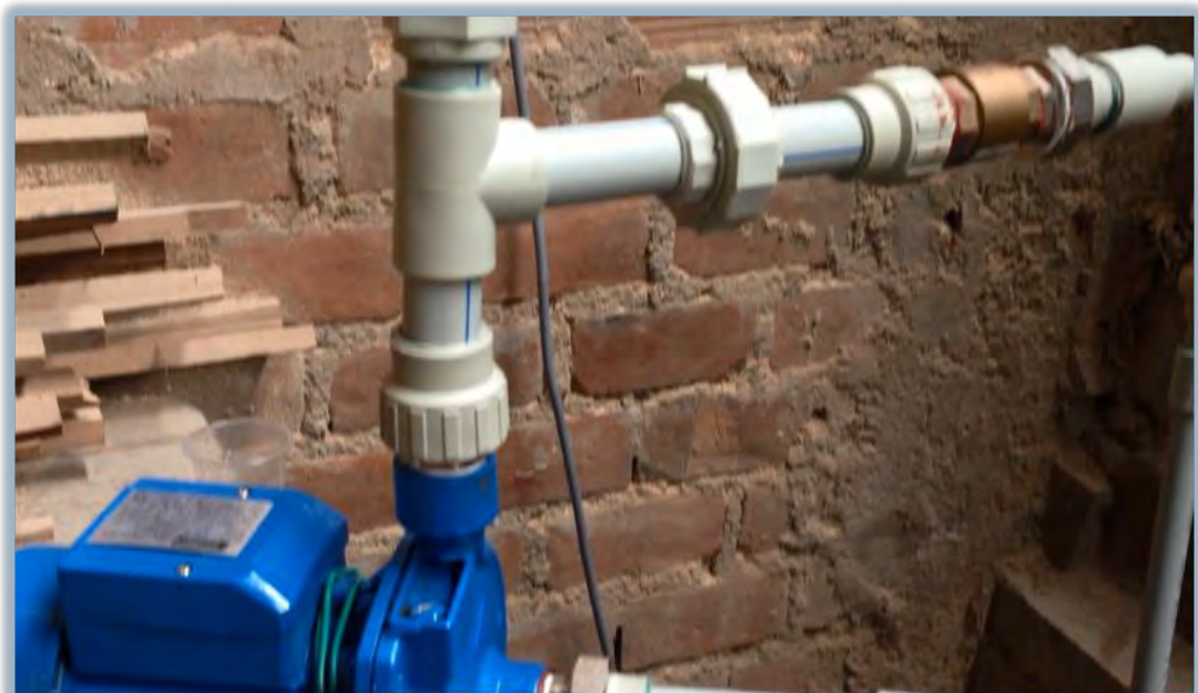
Foto n° 22: Línea de impulsión del sistema de bombeo
