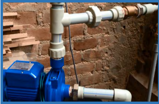
Foto n°45: Línea de Impulsión y Succión
