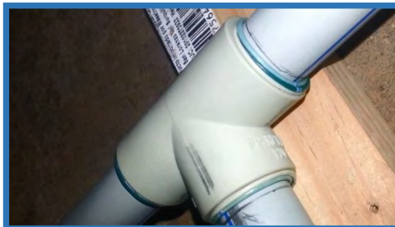
Foto n°73: Detalle de Tee de 20 mm PP-R.
