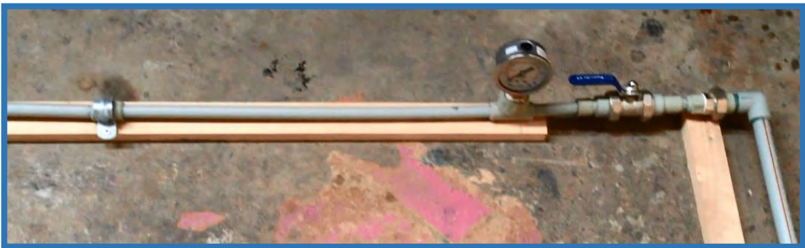
Foto n°50: Manómetro Punto Final, válvula de bola.
