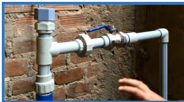
Foto n°59: Línea de impulsión 32 mm.
