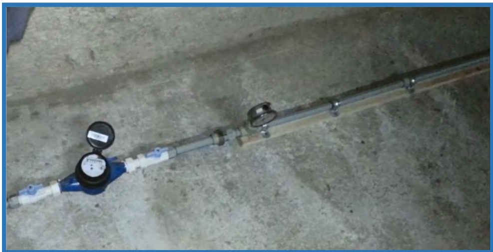
Foto n°55: Medidor de Caudal y Manómetro Punto Inicial tubería de 20 mm
