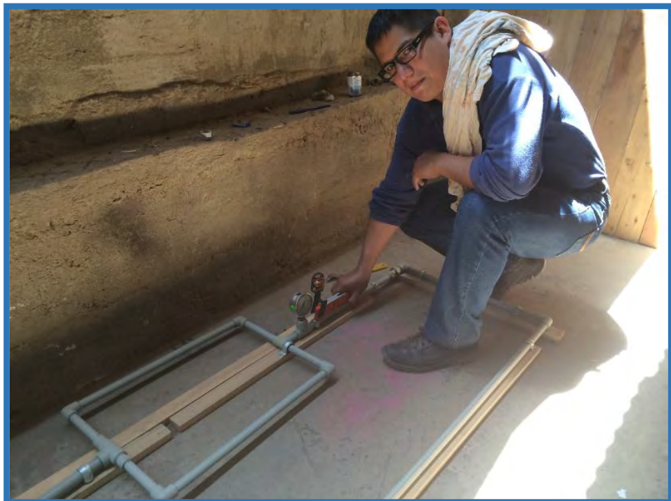
Foto n°41: Manómetro Punto Final
