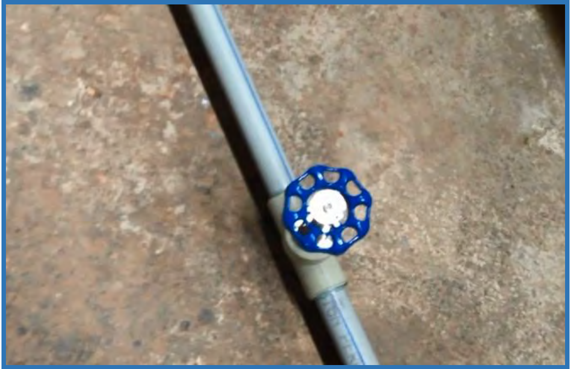
Foto n°79: Tubería de 16 mm, válvula de 20 mm manilla azul.
