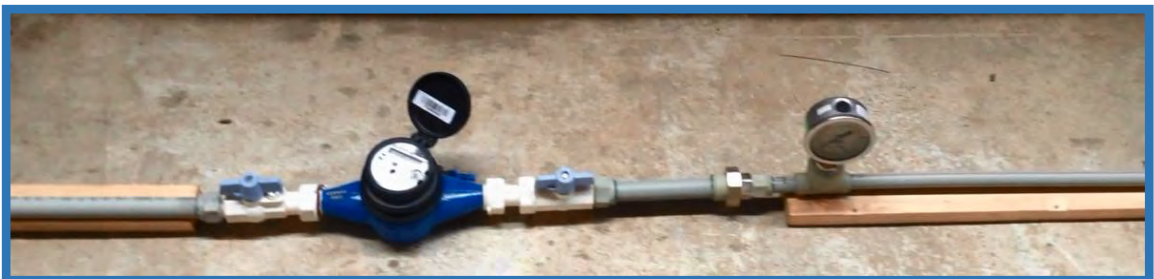
Foto n°48: Medidor, Manómetro Inicial y tubería de 16 mm
