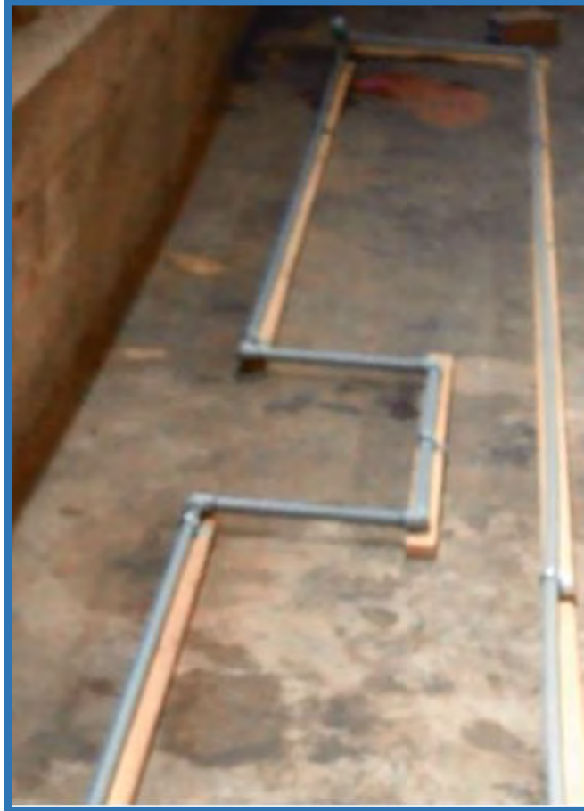
Foto n°69: Codos de 20 mm PP-R y Manómetro punto final.
