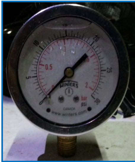
Foto n°27: Manómetros de 0-30 PSI.
