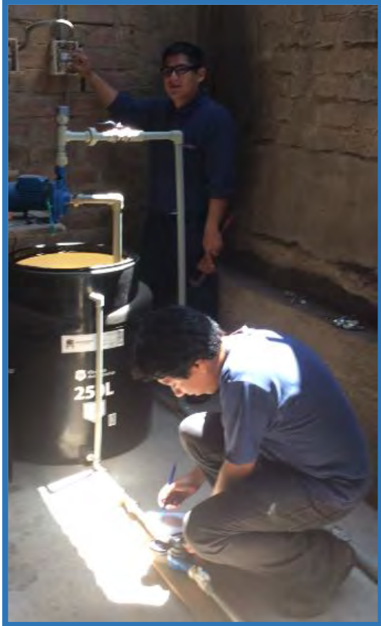
Foto n°38: Encendido del equipo de bombeo.
