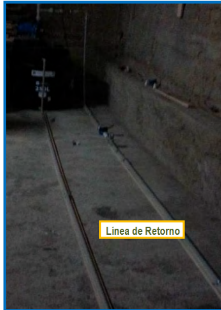
Foto n°31: Línea de Retorno.
