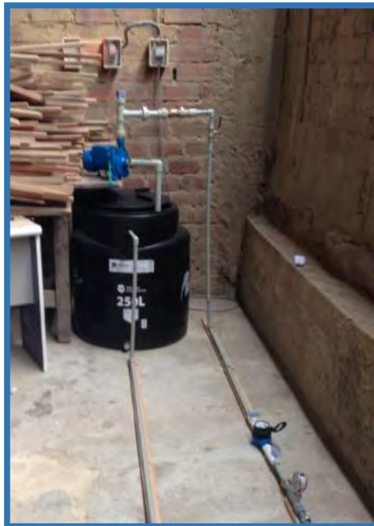
Foto n°86: Tubería de PVC
