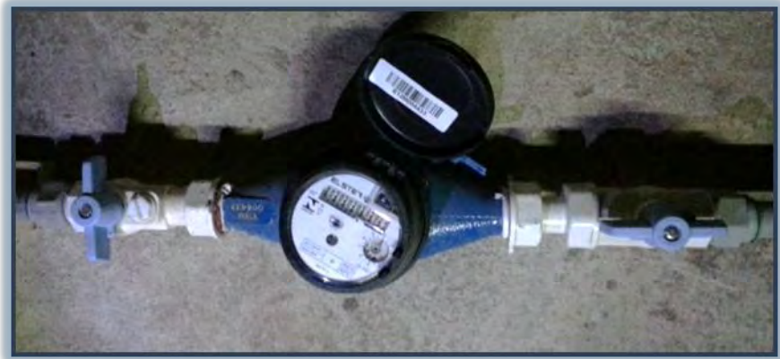
Foto n° 23: Medidor de Caudal.
