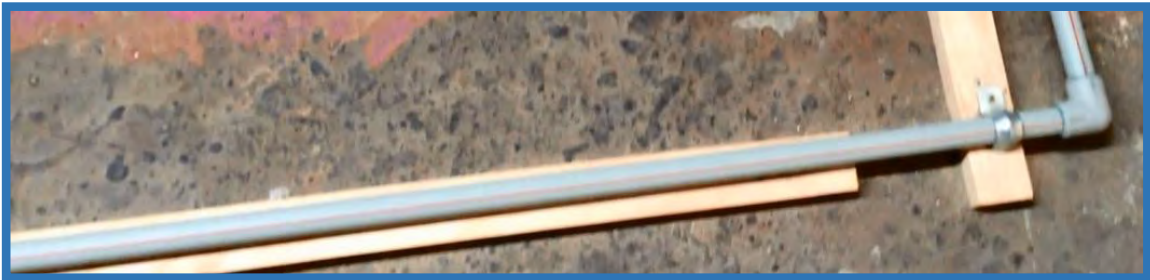
Foto n°51: Tubería De Retorno.
