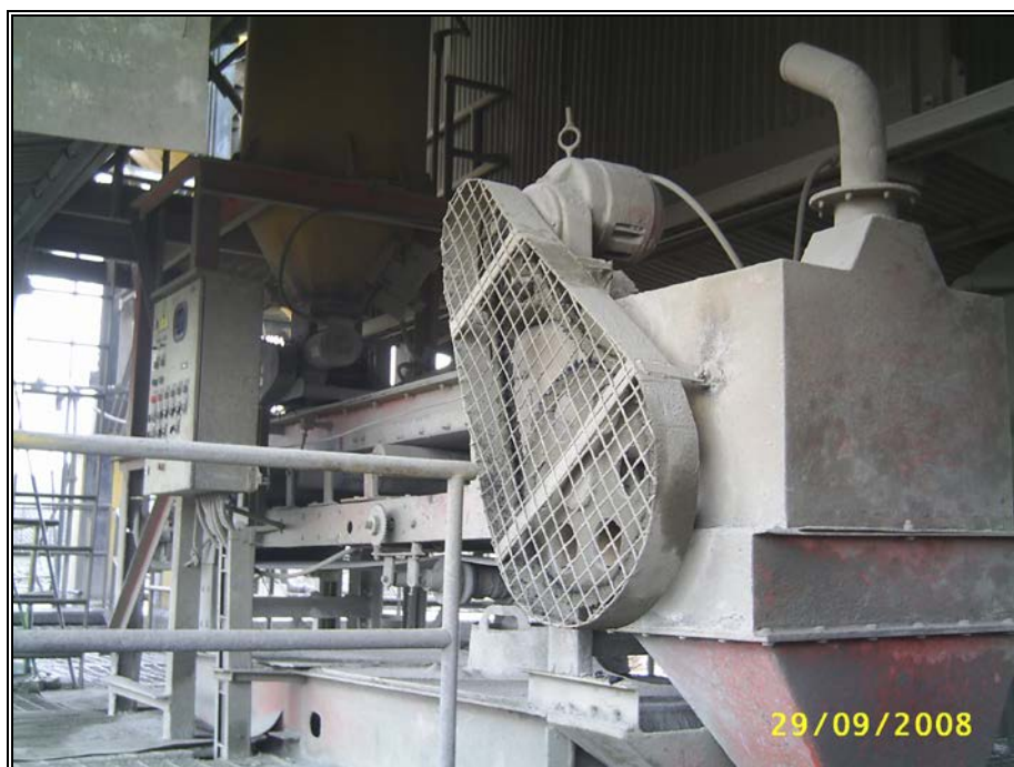
GRAFICO Nº 11: Dosificador automático de cemento
