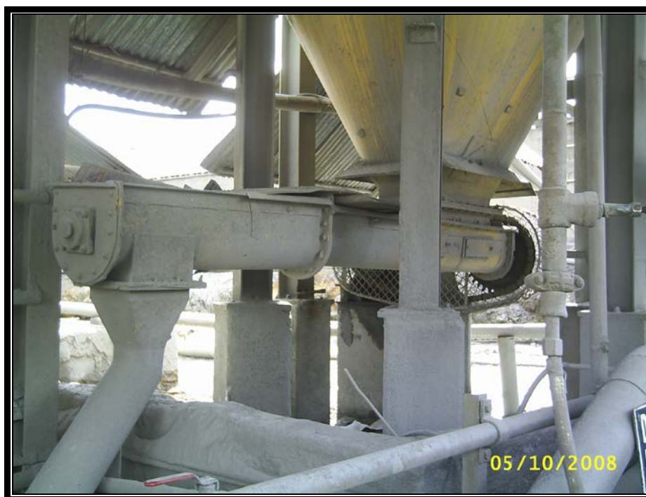
GRAFICO N° 10: Equipo mecánico de alimentación de cemento
