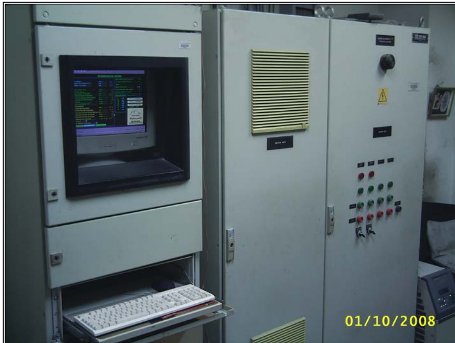
GRAFICO N° 06: Tablero de control electrónico
