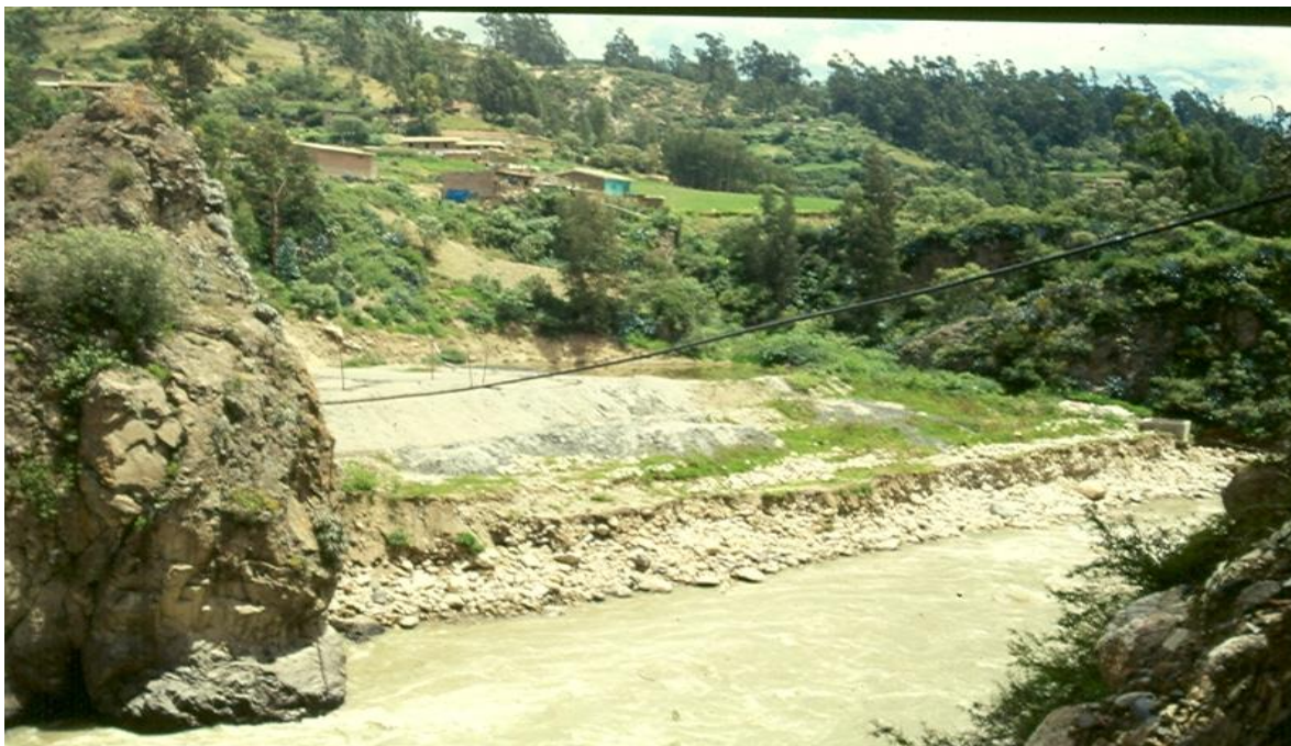
Cancha de Relave sin muro de concreto
