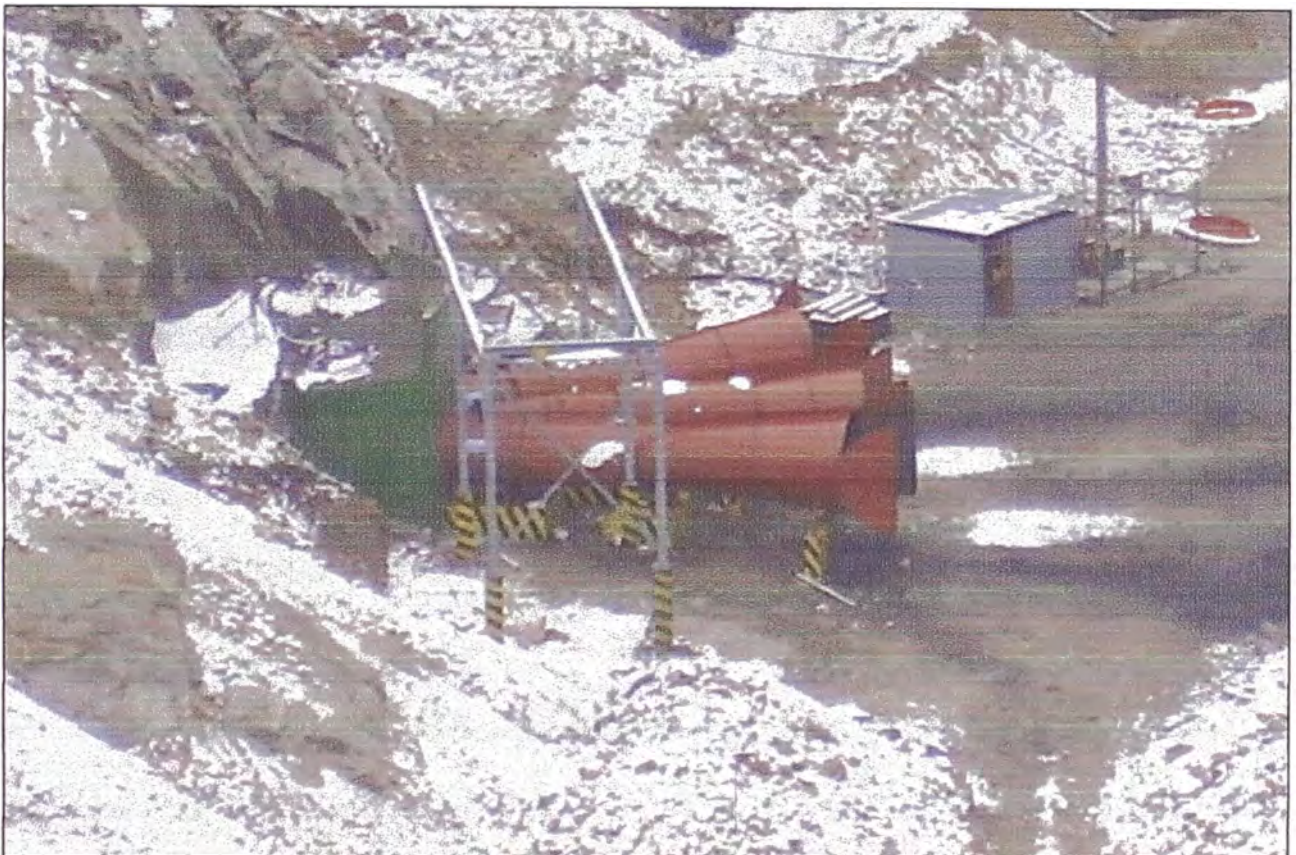
Foto N° 2: Bocamina Sur-ventiladores en Paralelo.
