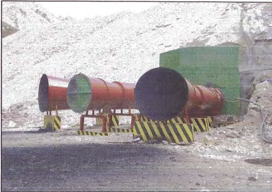
Foto N° 3: Donde se aprecia a los tres ventiladores en Bocamina Sur, instalados en Paralelo, cuando uno de ellos se encuentra apagado.
