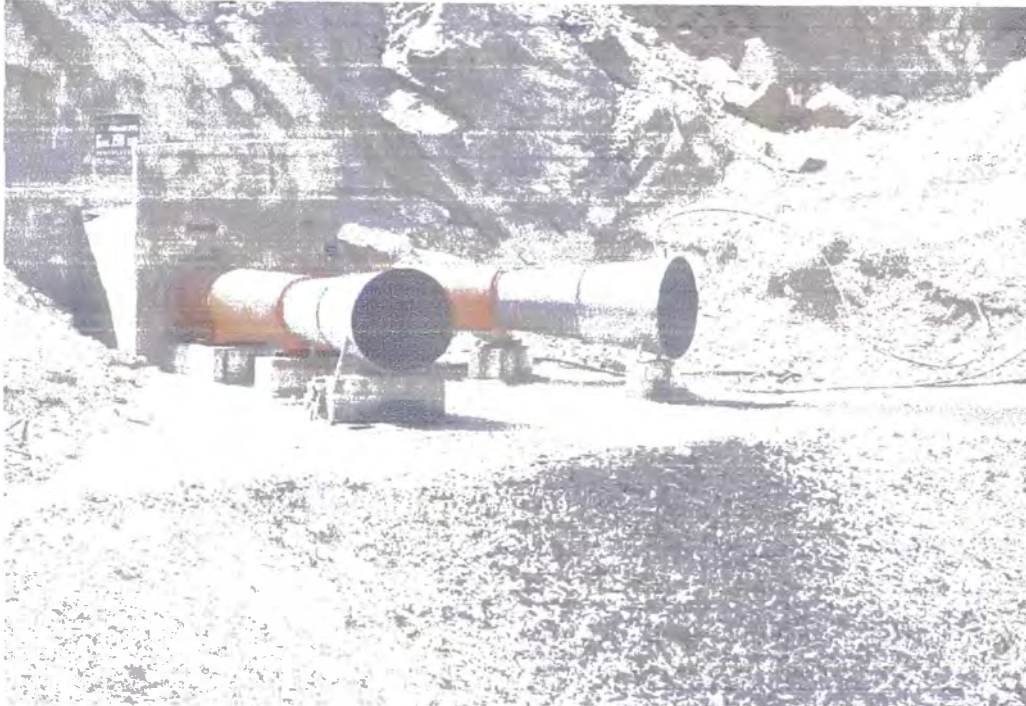
Foto N° 4: Donde se aprecia a dos ventiladores instalados en Bocamina Sur.
