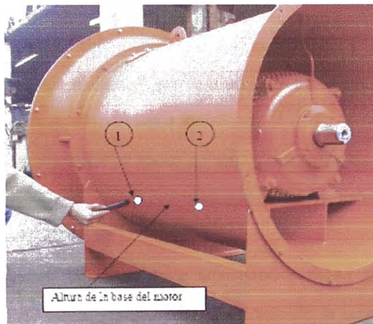
Foto N° 5: Forma de medir la Vibración de un ventilador.
