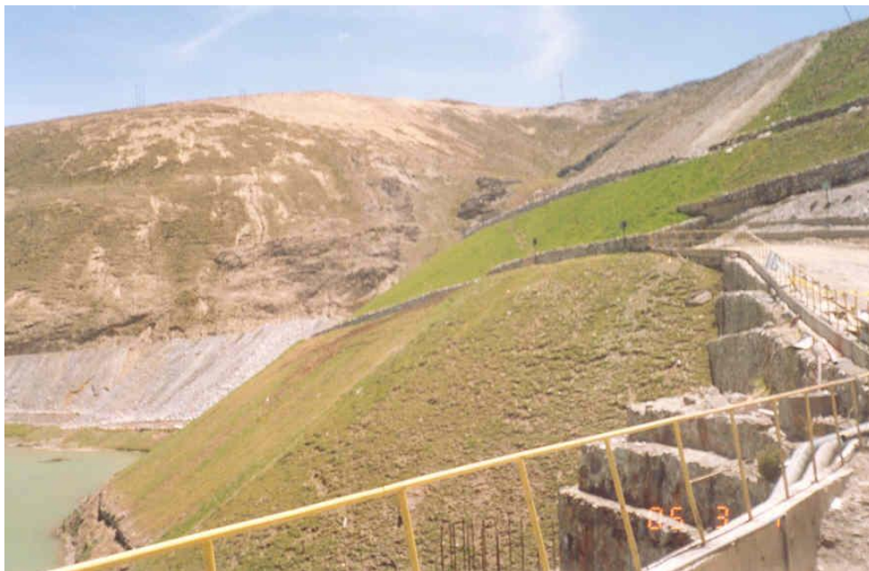
Foto N° 13: En esta desmontera existen pequeñas y discontinuas fisuras que indican que debe mejorar su estabilidad mediante la discriminación de su talud y construir banquetas con sus respectivas obras de drenaje.
