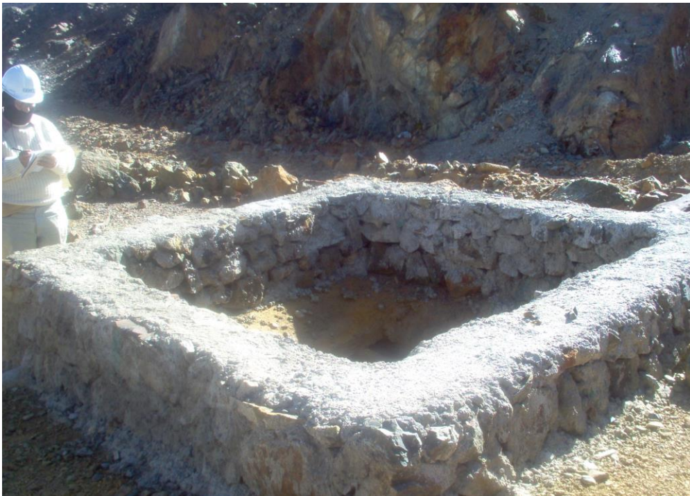
Foto N° 2: Chimenea 44, altitud 4908 msnm
