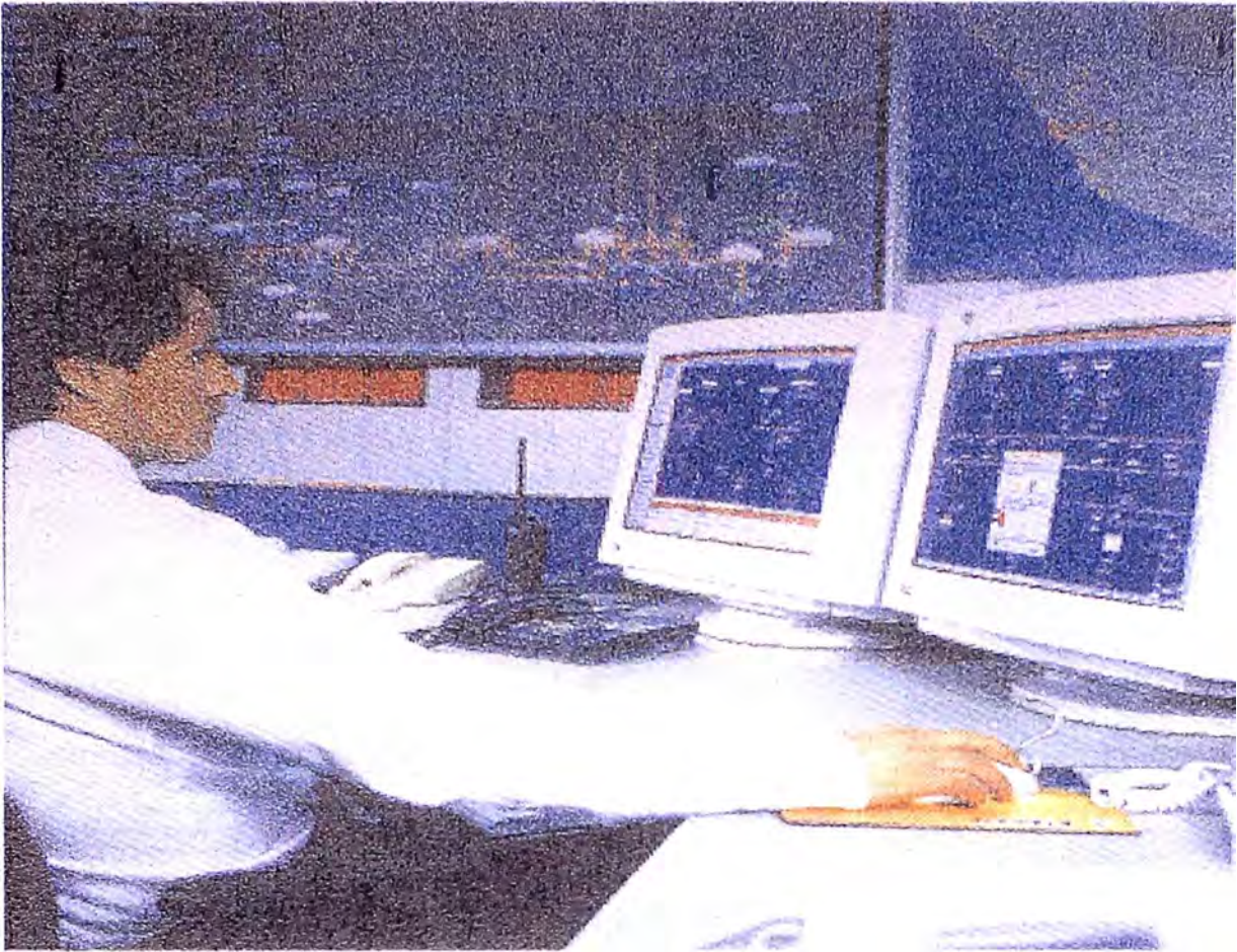
Fig. 2.2 Centro de Control de ETECEN
