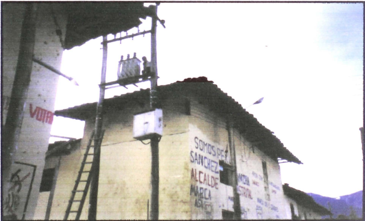
FERRETERIA DE SUB ESTACION
